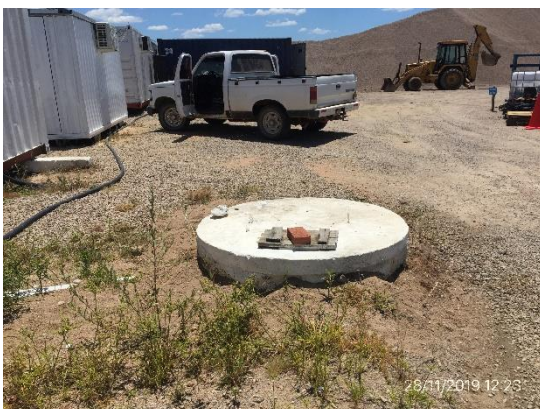
Ilustración 14 – Obrador principal – depósito impermeable para baños
