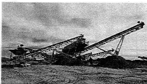
vista general planta trituradora
