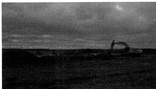
vista desde afuera del destape (a los lado vallado con tierra del destape)
