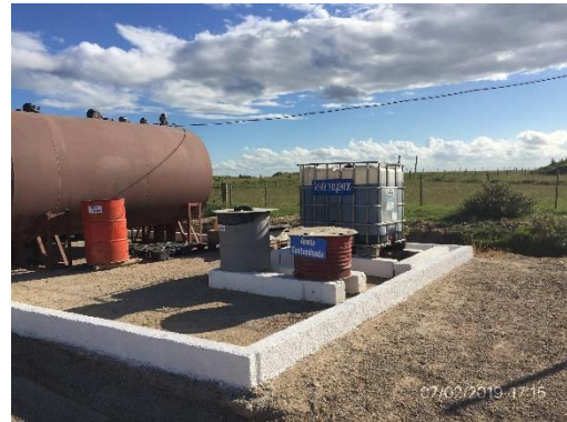
Ilustración 13 – Cantera – Acopio de lubricantes y combustible con envasado adecuado.
