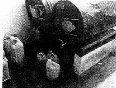
sistema de bandejas con arena para evitar derrames
