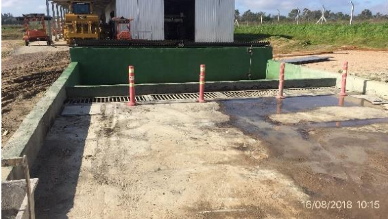
Ilustración 12 - Obrador CVC. Explanada de lavado con cámara sedimentadora
