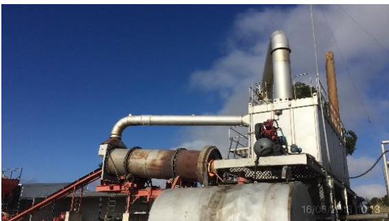
Ilustración 10 - Planta asfáltica CVC con filtro de mangas
