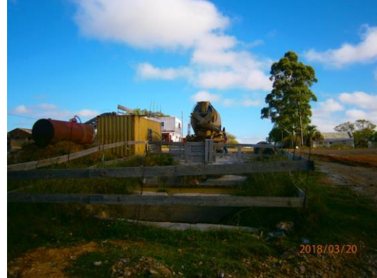
Ilustración 6 - Zona lavado de mixer.
