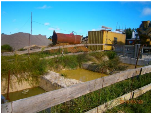
Ilustración 7 - Zona de lavado de mixer.
