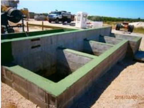
Ilustración 16- Pileta de lavados
