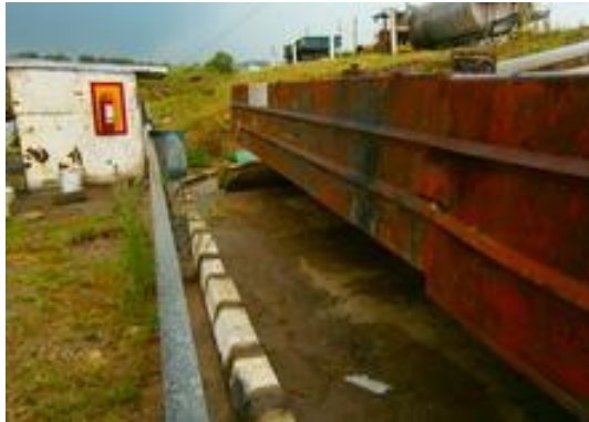
Ilustración 5 - Tanque de combustible con contención perimetral. Al fondo casilla de surtidor con tambor de gasoil
