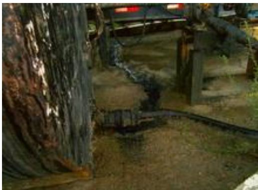
Ilustración 9 - Planta asfáltica y contención correspondiente.
