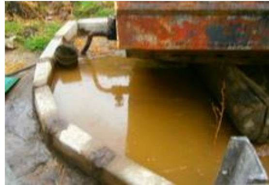
Ilustración 6 - Tanque de combustible con contención perimetral.
