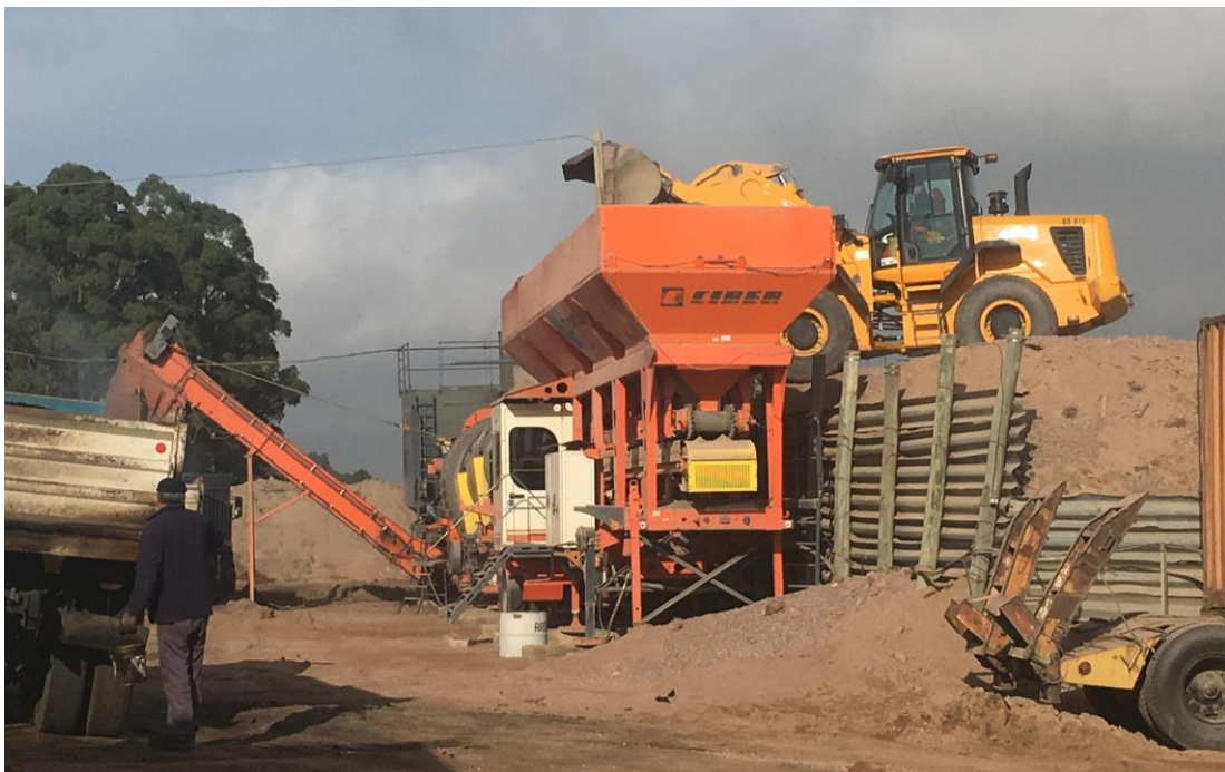
Planta asfáltica en funcionamiento. No se observan emisiones.
