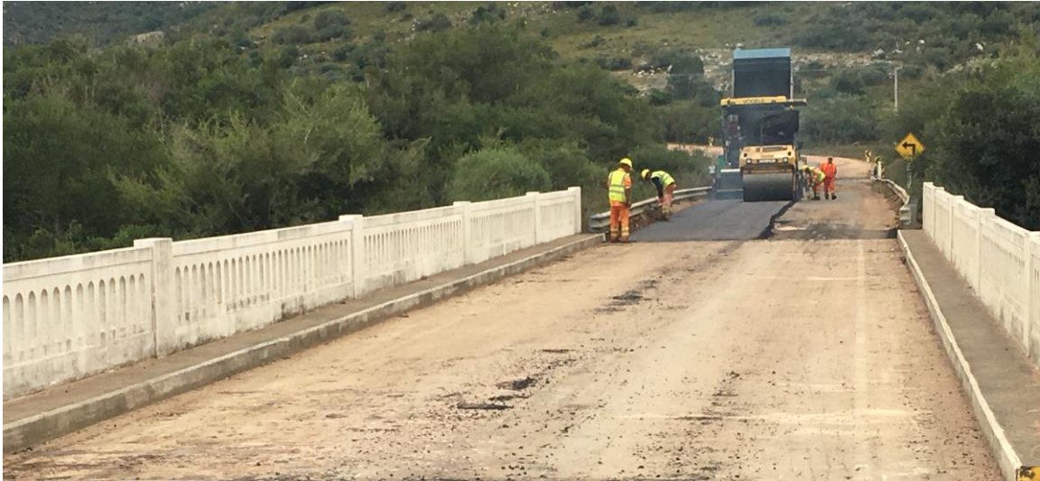
Tendido de asfalto. Desde losa de acceso puente Ao La Llana hacia Aigua.
