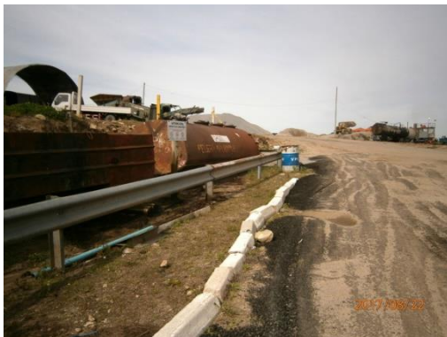
Ilustración 9 – Tanques de combustible.
