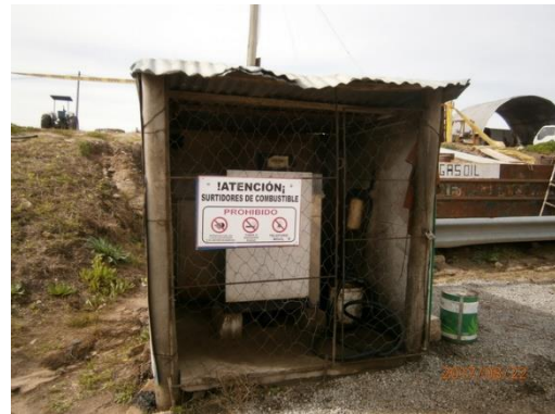
Ilustración 8 – Surtidor de combustible.
