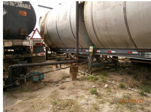
Ilustración 20 – Planta de asfalto.
