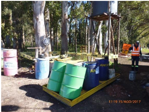
Ilustración 11 - Obrador. Tanques en bandeja metálica.
