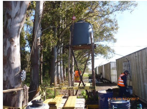
Ilustración 12 - Obrador. Tanque elevado de agua.
