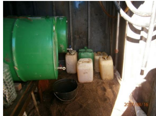
Ilustración 19 – Depósito de hidrocarburos.
