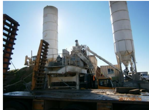
Ilustración 13 – Planta de hormigón.
