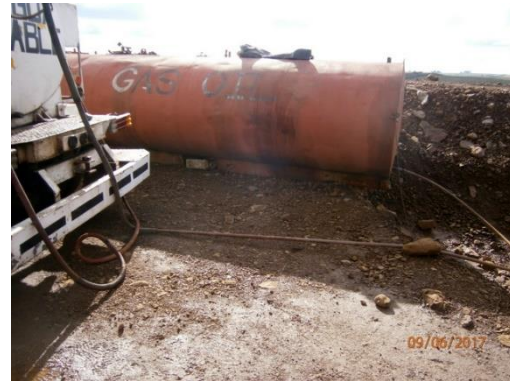
Ilustración 5 - Tanque de gasoil conectado al camión surtidor. Tanque operando pero aún no ha sido colocado sobre contención.
