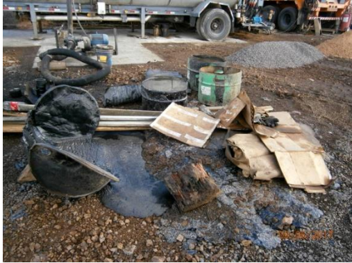
Ilustración 10 - Residuos contaminados en zona de trasiego de planta asfáltica.
