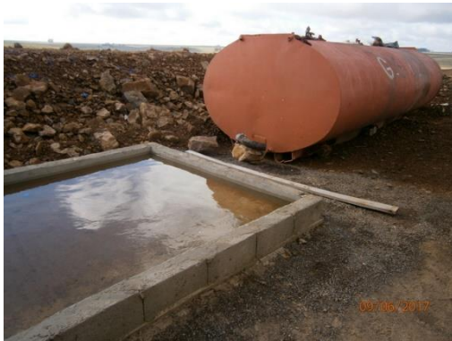
Ilustración 4 - Pileta para contención de gasoil en vías de implementación. Tanque aún sin ser instalado en el lugar correspondiente.
