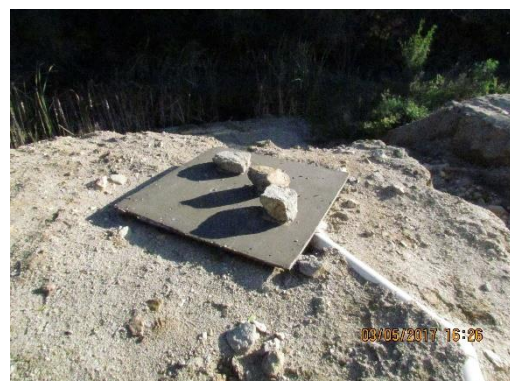
Ilustración 28 - Obrador nuevo. Erosión por pluviales junto al depósito fijo impermeable de baños.
