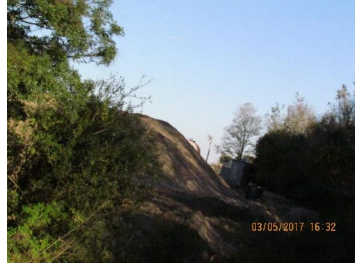
Ilustración 30 - Obrador nuevo. Acopios de áridos y oficina sobre margen del Arroyo Melo
