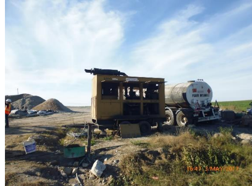
Ilustración 18 - Obrador nuevo. Generador para planta asfáltica y tanque de asfalto
