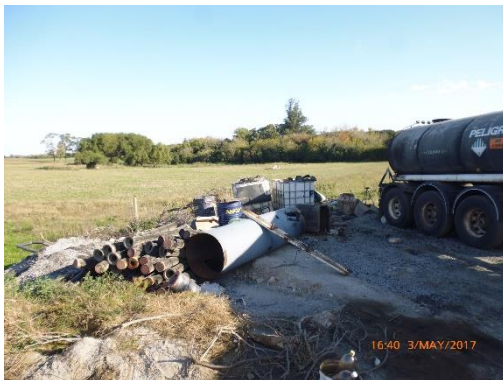
Ilustración 19 - Obrador nuevo. Residuos varios detrás del tanque de asfalto.
