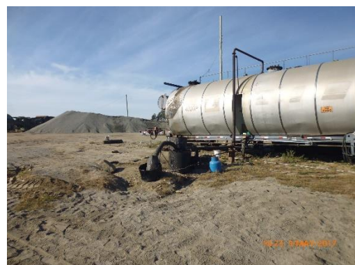
Ilustración 22 - Obrador nuevo. Tanque para calentar asfalto para planta. Sin medidas de contención.
