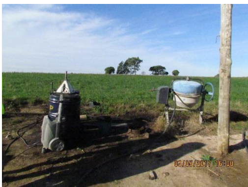
Ilustración 15 - Obrador nuevo. Tanques de combustible y hormigonera
