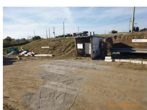
Ilustración 10 - Obrador nuevo. Surtidor de gasoil de lado a los depósitos. Arena cubriendo derrames de gasoil.
