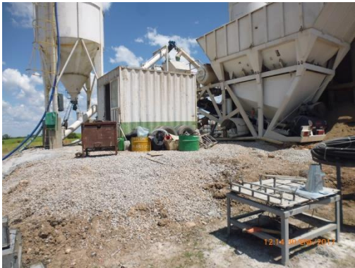
Ilustración 16 – Planta de hormigón
