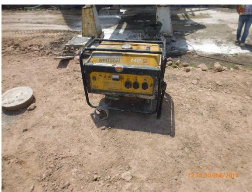
Ilustración 20 – Generador sin bandeja de contención
