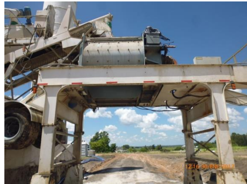
Ilustración 17 – Planta de hormigón
