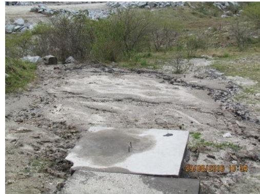
Ilustración 7 – Desborde de la cámara de la zona de lavado de maquinaria.
