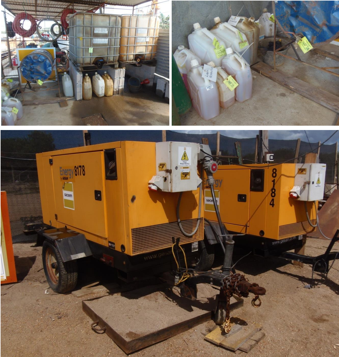
Figura 3-1 Recinto de combustibles, uso de bandeja bajo generadores
