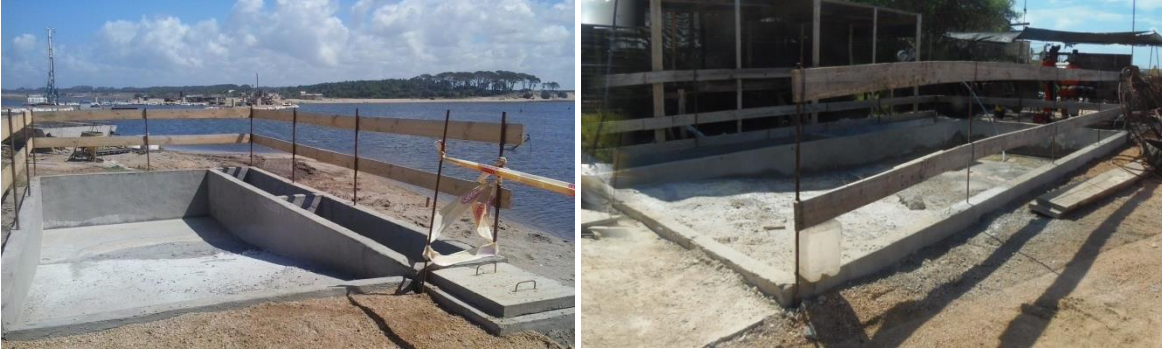
Figura 4-3 Pileta de lavado de mixer lado Este y Oeste
