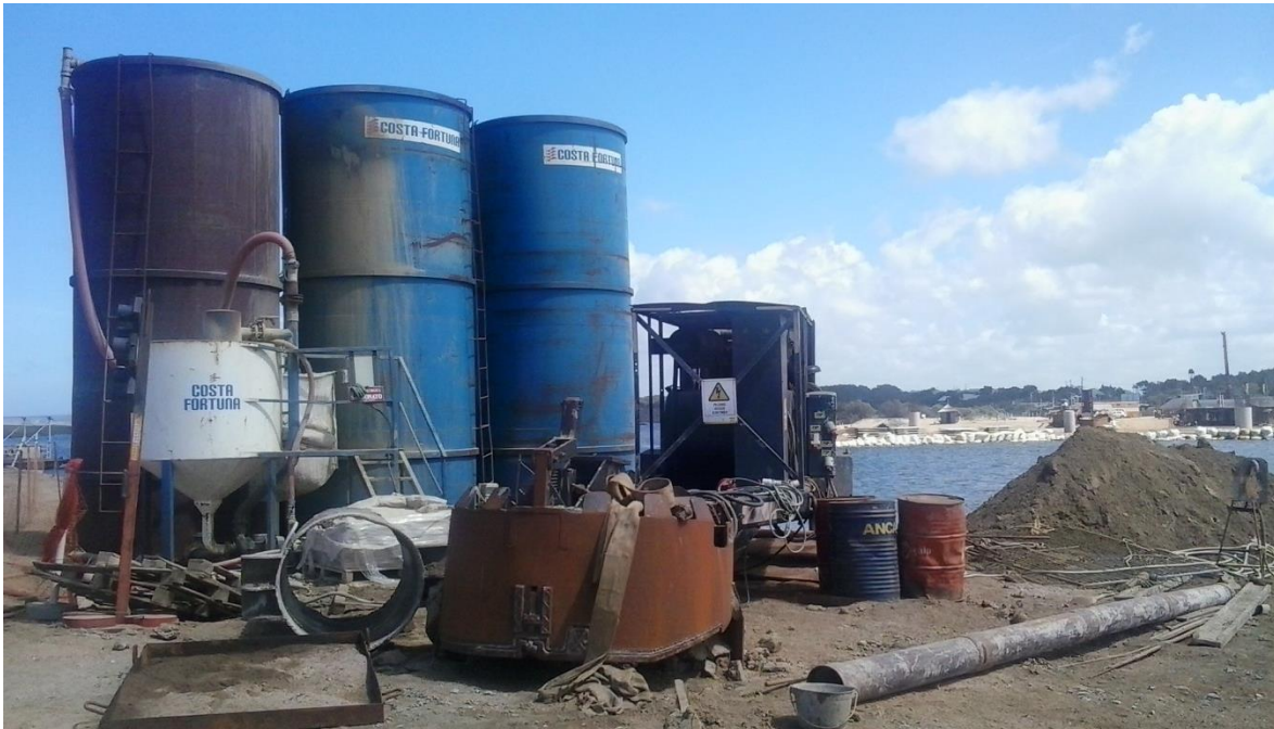
Figura 2-4 Tanques de recirculación de Bentonita
