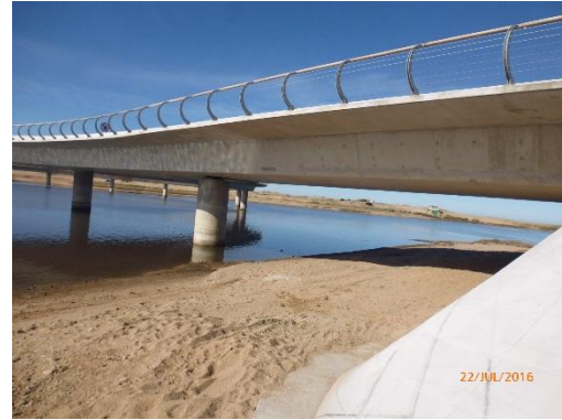
Ilustración 5 – Vista del puente. Se observan las barandas y revestimiento objeto del contrato AB17.
