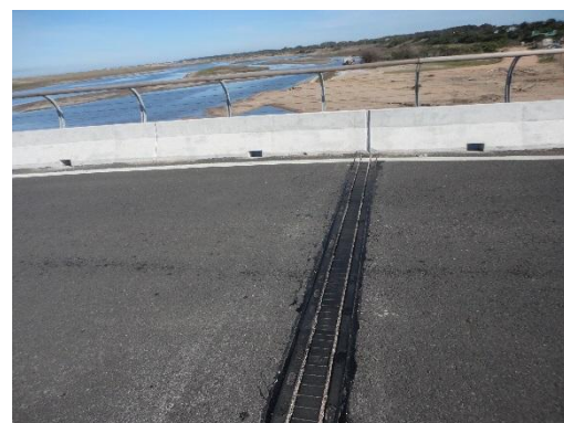
Ilustración 9 – Juntas transversales en pavimento. Contrato AB17.
