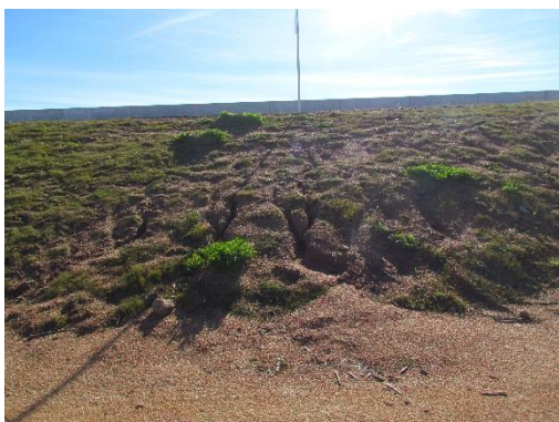
Ilustración 8 – Cárcavas por lluvia en el terraplén de acceso al puente.
