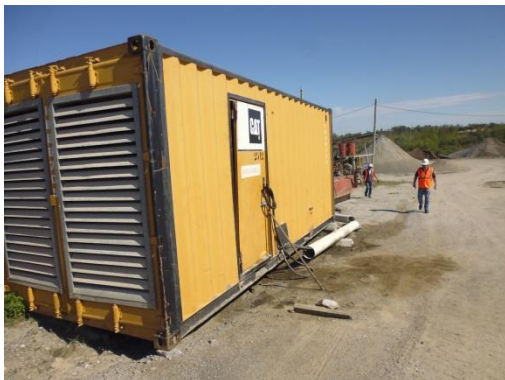
Ilustración 13 – Generador de la planta trituradora. Se solicita disponer de contención para posibles fugas.
