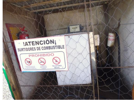
Ilustración 24 – Surtidor de los tanques de combustible.
