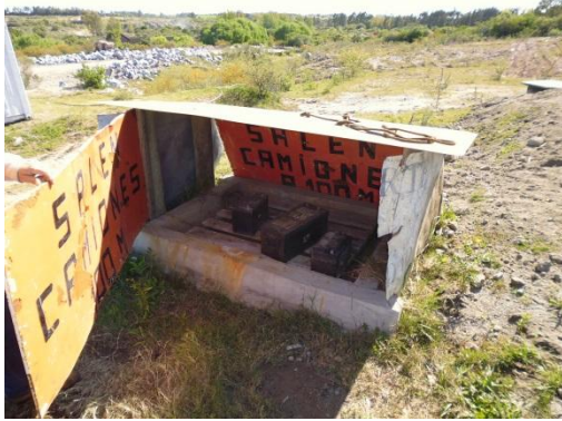
Ilustración 11 – Las baterías usadas se almacenan bajo techo y con contención para posibles vertidos.
