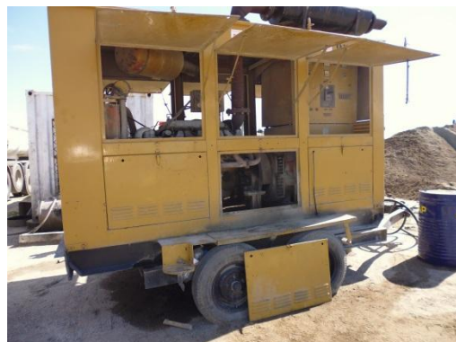
Ilustración 16 – Generador de la planta asfáltica. Se solicita disponer de contención para posibles fugas.
