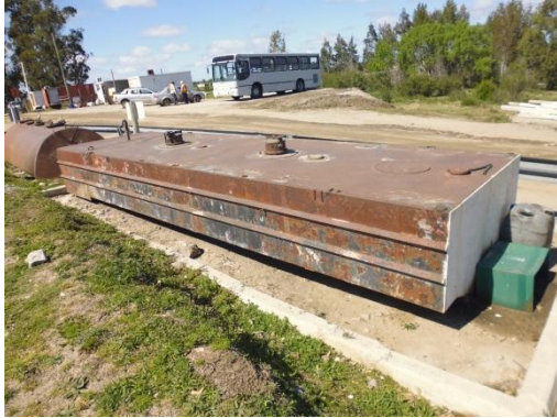
Ilustración 23 – Tanques de combustible con contención perimetral.
