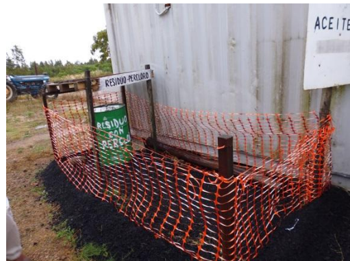
Ilustración 9 - Tanques identificados y con contención.
