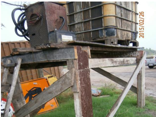
Ilustración 7-Tanque de almacenamiento de gasoil
