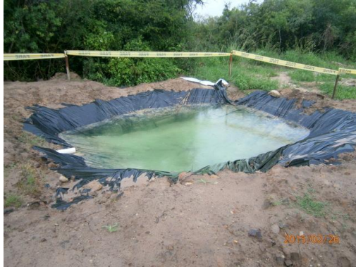
Ilustración 11-Tercera pileta en serie para el lavado del mixers
