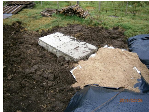
Ilustración 6-Cámara separadora para el efluente generado en zona de almacenamiento de hidrocarburos
