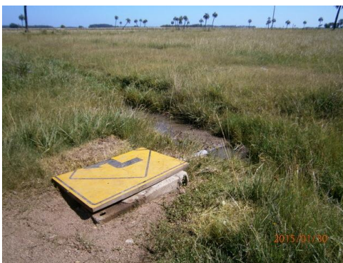
Ilustración 9-Cámara separadora de hidrocarburos
