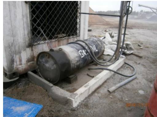
Ilustración 23-Sistema de contención en planta asfáltica
