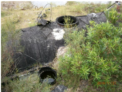
Ilustración 18-Tanque de asfalto abandonado y recipientes con agua
