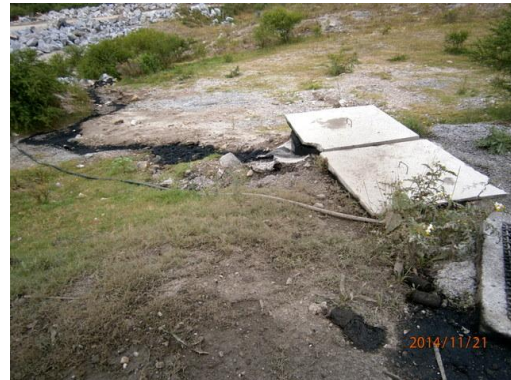
Ilustración 11-Efluente de la pileta de lavado de máquinas
