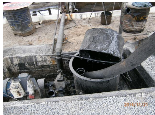
Ilustración 21-Sistema de contención en planta asfáltica
