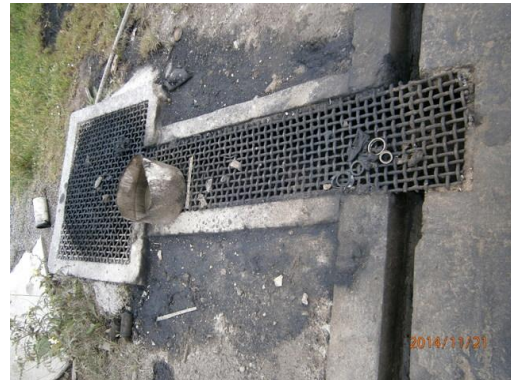
Ilustración 13-Cámara de separación de lodos e hidrocarburos
