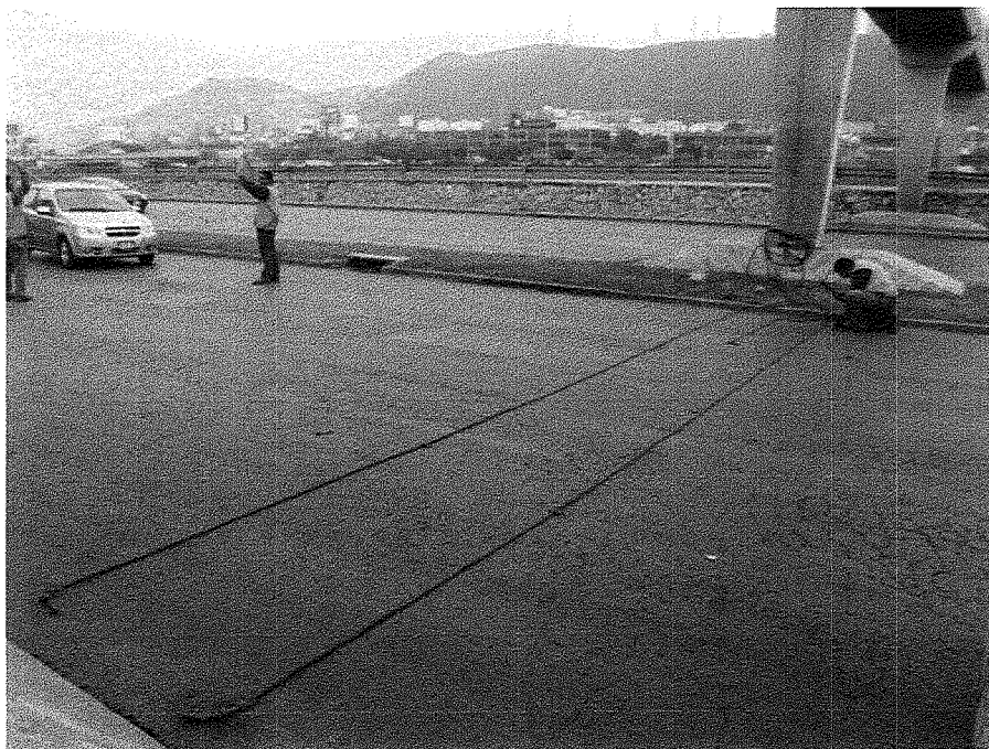
Figura 6. Instalación de estaciones de aforo neumático en México
