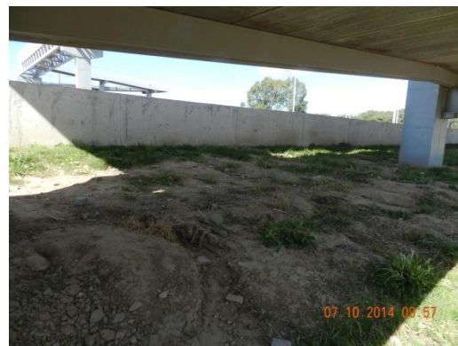
Ilustración 9: Suelo con escombros, sin restaurar y talud sin perfilar)
