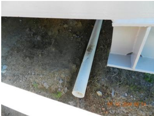
Ilustración 12: Tubo de descarga de pluviales sin protección y suelo con escombros y sin restaurar
