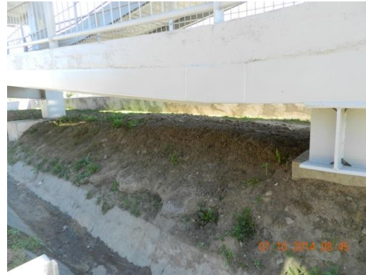
Ilustración 7: Talud sin restaurar ni perfilar
