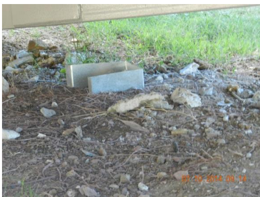
Ilustración 10: Residuos y escombros debajo del pasaje peatonal, en zona con suelo sin restaurar
