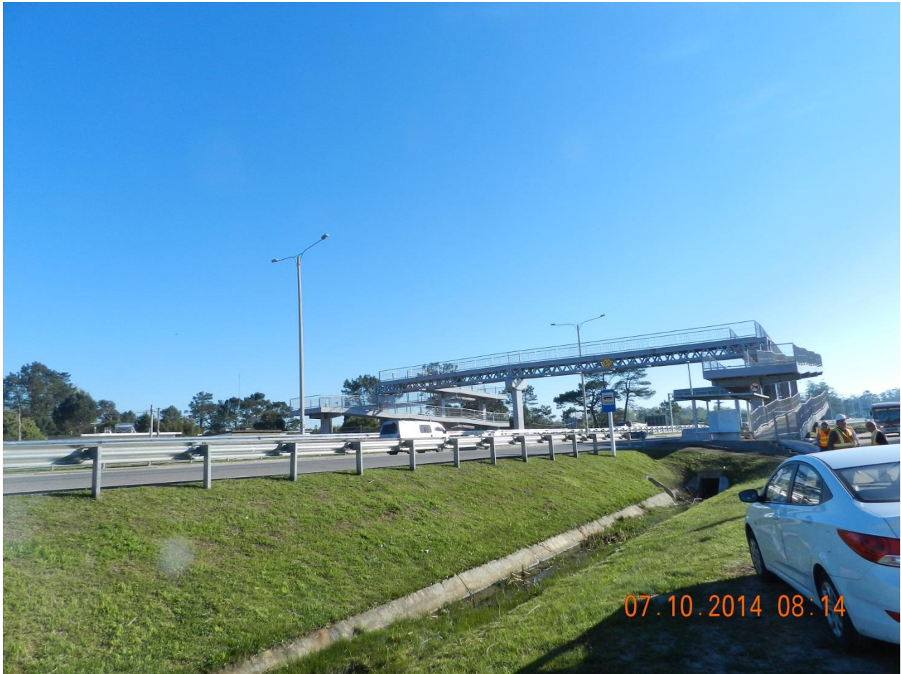
Ilustración 5: Pasaje peatonal en progresiva 33K500 de la ruta IB representativo de todos los proyectados y construidos en el presente contrato, donde se observa que las rampas de acceso y los pilares están a ambos lados de la doble vía (++) y (- -), y tiene un solo apoyo intermedio en el cantero central
