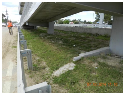
Ilustración 11: Tubo de descarga de pluviales protegido contra vandalismo y contra la erosión al descargar en el terreno
