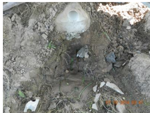
Ilustración 17: Desagüe en tierra no estabilizada y sin medidas contra la erosión
