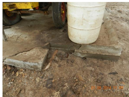
Ilustración 10: Piso de cemento fracturado en zona de residuos peligrosos
