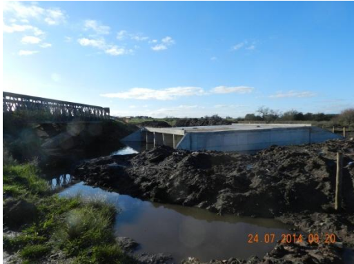
Ilustración 5: Puente Bailey sobre arroyo El Cuadro a la izquierda y alcantarilla en construcción a la derecha.
