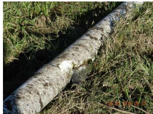
Ilustración 8: Tubería de desagüe del baño de la oficina con una rotura parcial.
