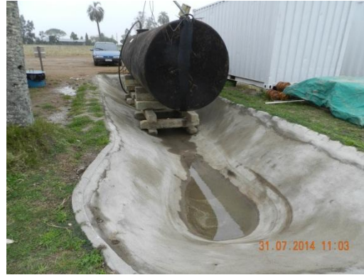
Ilustración 6: Depósito de combustible con sistema de protección contra derrames
