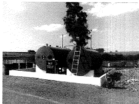
depósitos de combustible
