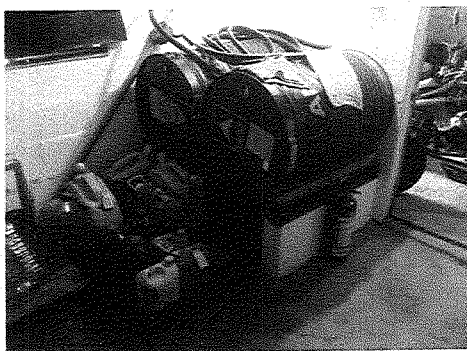
depósito de lubricantes
