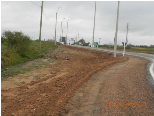
Ilustración 29: Talud del terraplén sin protección próximo a la rotonda inicial en San José
