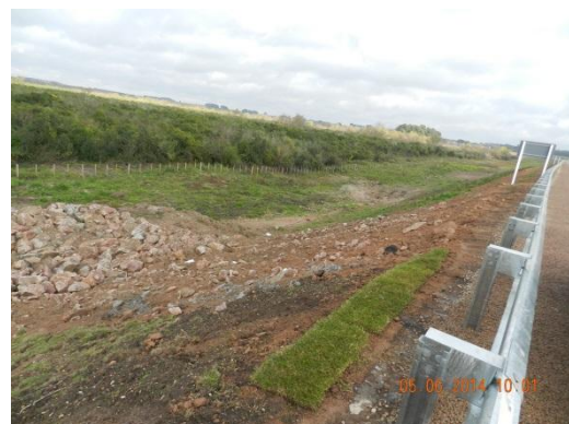
Ilustración 22: Talud en terraplén con protección parcial próximo al puente en San José del lado sur
