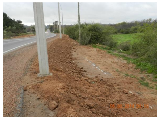
Ilustración 28: Talud de terraplén sin protección y calzada de ruta vieja sin escarificar del lado sur próximo al puesto de peaje
