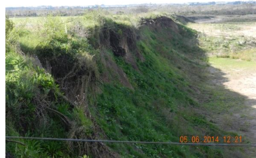
Ilustración 6: Talud en desmonte (frente de cantera) sin suavizar y alambrado en el aire de la cantera de limo en predio del Sr. Romero
