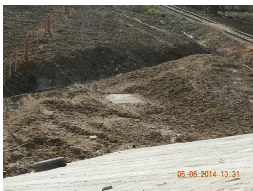
Ilustración 15: Residuos (neumáticos usados) próximos a la pasarela del ferrocarril en progresiva 83K595 a (-)
