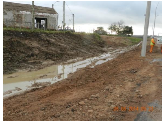
Ilustración 30: Cuneta sin un adecuado drenaje en zona próxima al obrador secundario
