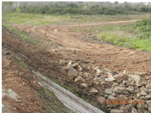
Ilustración 19: Camino de servicio sin restaurar próximo al puente en Canelones del lado sur
