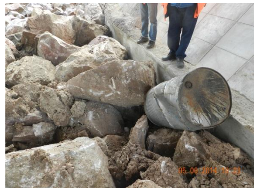
Ilustración 14: Residuos (tanque vacío) debajo del puente en progresiva 83K300
