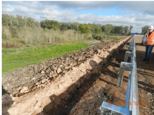
Ilustración 17: Talud en terraplén sin medidas de protección de erosión en Canelones del lado sur
