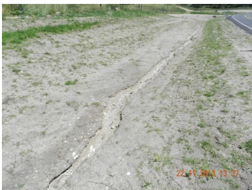
Ilustración 8: Cuneta con erosión y taludes sin tierra fértil
