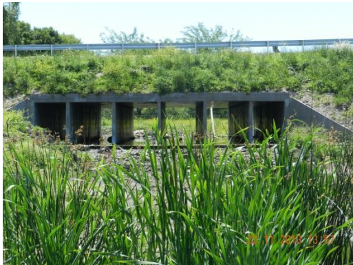
Ilustración 6: Alcantarilla tipo H de 6 bocas
