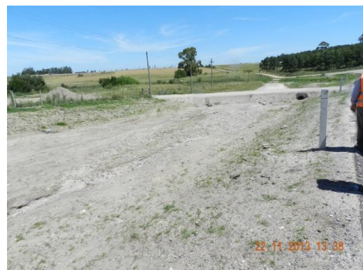
Ilustración 9: Entrada a predio del INIA La Estanzuela con 1 alcantarillas nueva (derecha) que no trabaja y otra muy baja
