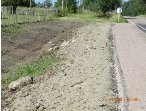
Ilustración 4: Talud del terraplén sin tierra fértil ni hierbas sembradas en torno a progresiva 43K130 a (+)
