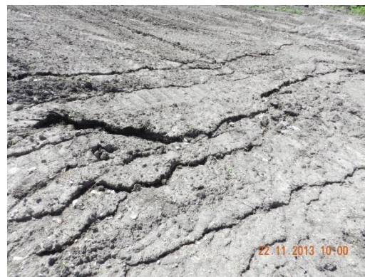
Ilustración 9: Talud del terraplén a la salida del nuevo puente a (+) con tierra fértil pero con signos de erosión e inestabilidad
