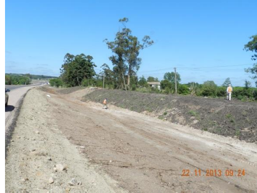
Ilustración 5: Talud del terraplén sin tierra fértil ni hierbas sembradas en torno a progresiva 44K150 a (-)
