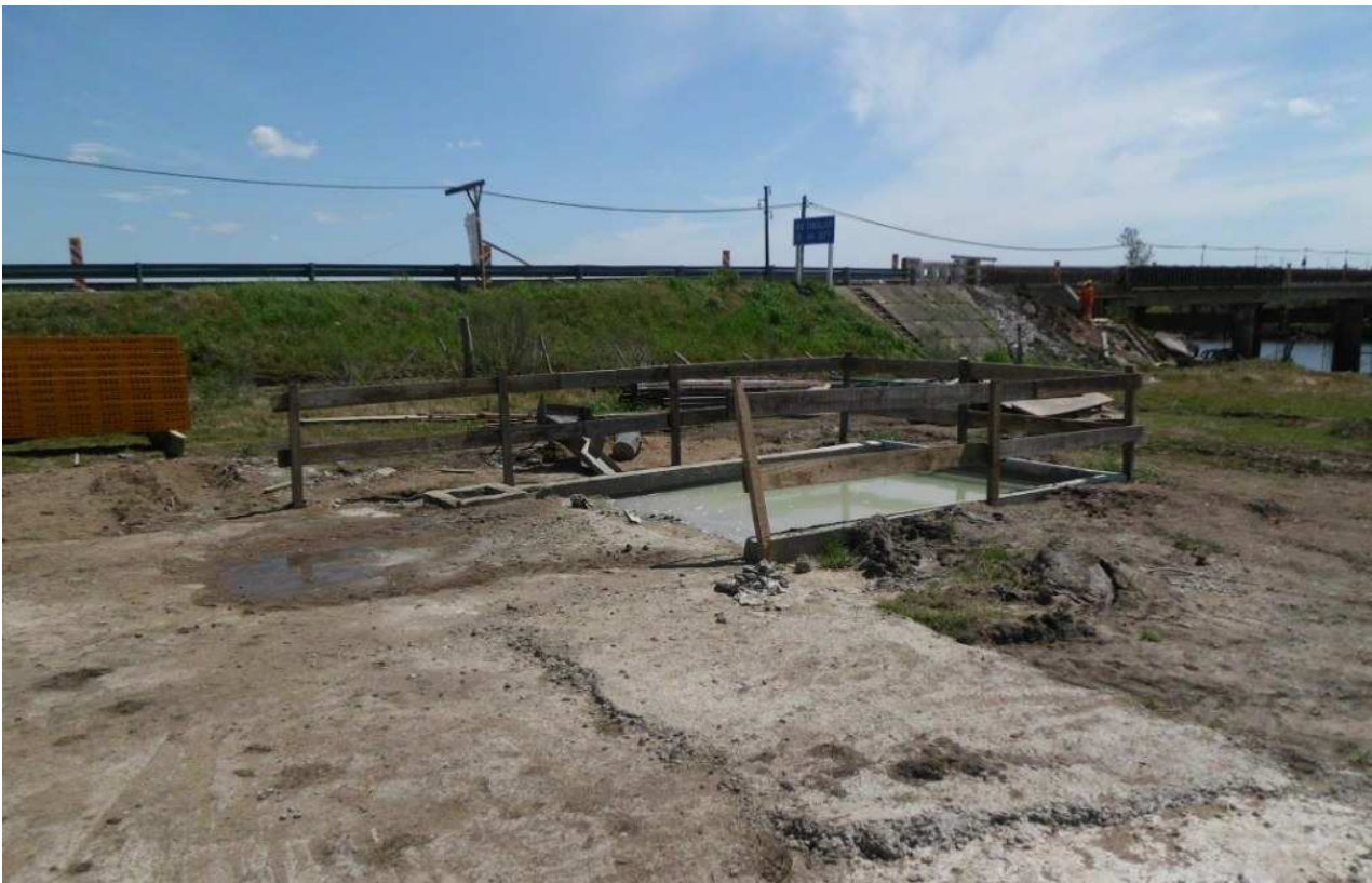
Figura 13: Pileta de lavado de hormigón
