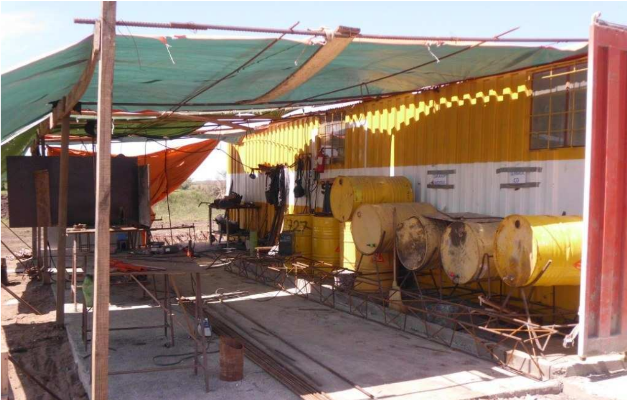
Figura 4: Taller de soldadura y acopio productos Sika
