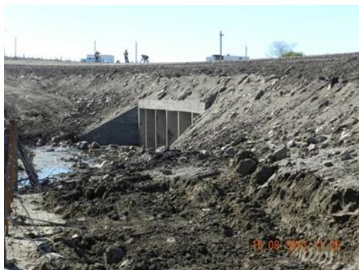
Ilustración 6: Alcantarilla tipo H de 6 bocas
