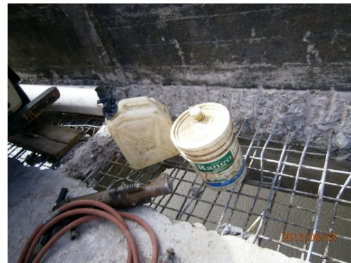
Ilustración 14-Recipientes con restos de hidrocarburos en el frente de obras sobre el ensanche del puente
