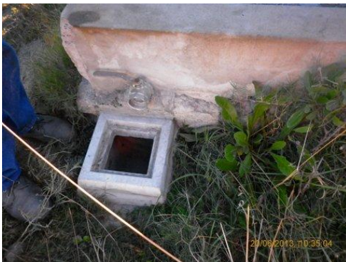
Ilustración 6 - Cámara para drenaje de piletas de contención, campamento Cerro Pelado
