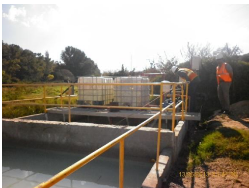
Ilustración 11- Pileta de lavado de camiones
