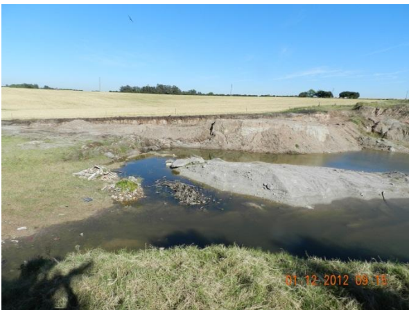
Ilustración 7: Restos de obra y acumulación de agua en zona de extracción
