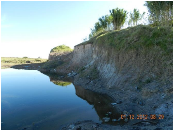
Ilustración 9: Taludes sin perfilar y acumulación de agua en la cantera
