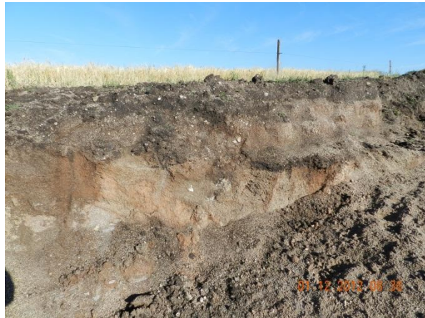
Ilustración 10: Taludes sin perfilar y cerca eléctrica colocada por el propietario del predio
