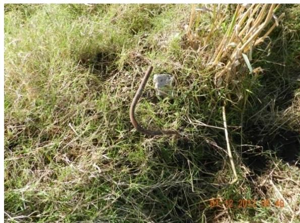
Ilustración 14: Varillas de hierro y restos de hormigón armado parcialmente enterrados
