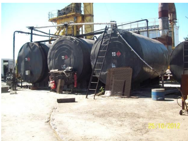
Ilustración 8 – tanques de la planta asfáltica sin contención
