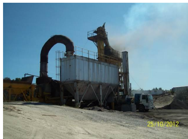
Ilustración 9 – planta asfáltica en obrador Siete Cerros
