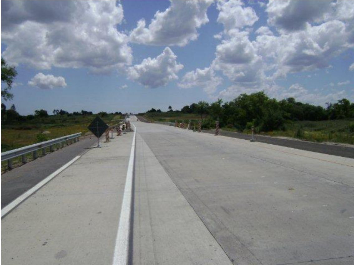
Vista actual del Puente S/Aº Miguelete (ver señalización provisoria, defensas metálicas).
