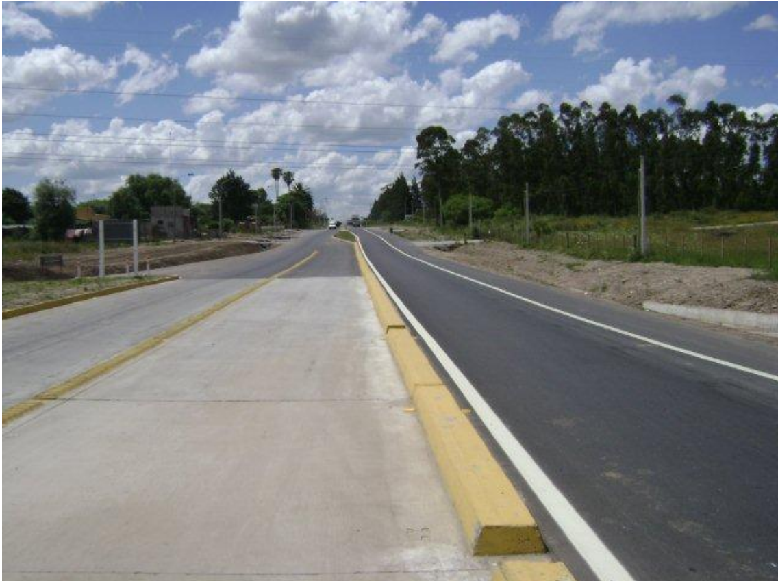
Vista del empalme del ACP con Cno. Mendoza, por Mendoza hacia el norte (ver señalización, entradas particulares terminadas y faja terminada).
