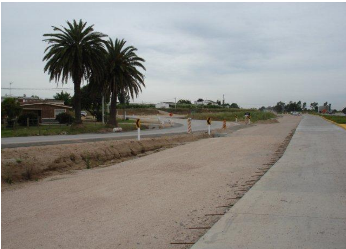
EMPALME FAUQUET LADO A (-). FALTA CONFORMACIÓN DE TALUD Y REVESTIMIENTO VEGETAL.
