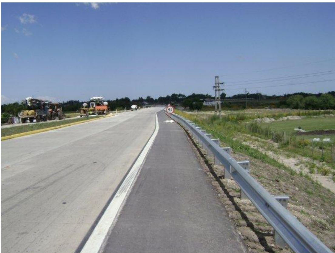
Empalme del ACP con Cno. Mendoza, progresivas mayores (pavimentadota instalada en el carril norte ACP, lista para comenzar a pavimentar). Ver defensas metálicas instaladas lado sur.
