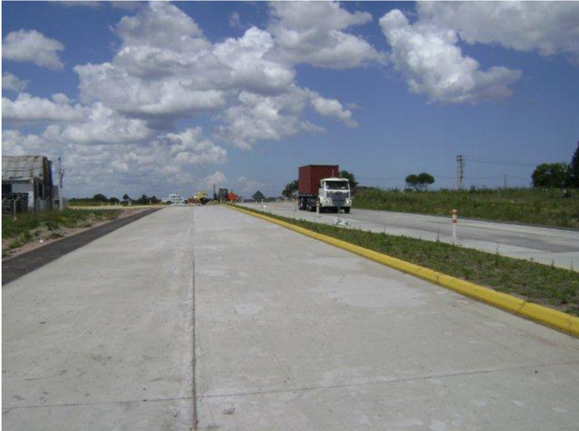
Empalme del ACP con Cnel. Raíz, progresivas menores (carril norte ACP, no habilitado al tránsito todavía).
