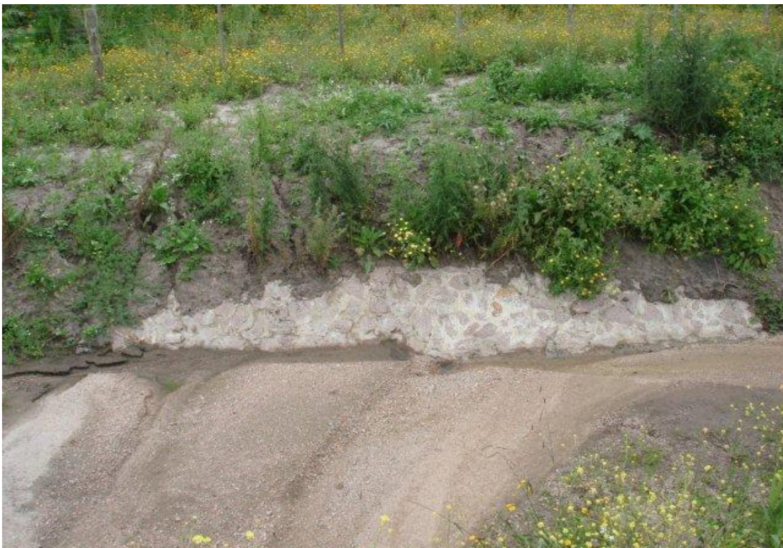
PROTECCIÓN CON PIEDRA REJUNTADA EN COMIENZO CANAL CAÑADA DEL DRAGÓN Y SALIDA DE ALCANTARILLA 1+975 A (+). FALTA LIMPIEZA DE ARRASTRE.
