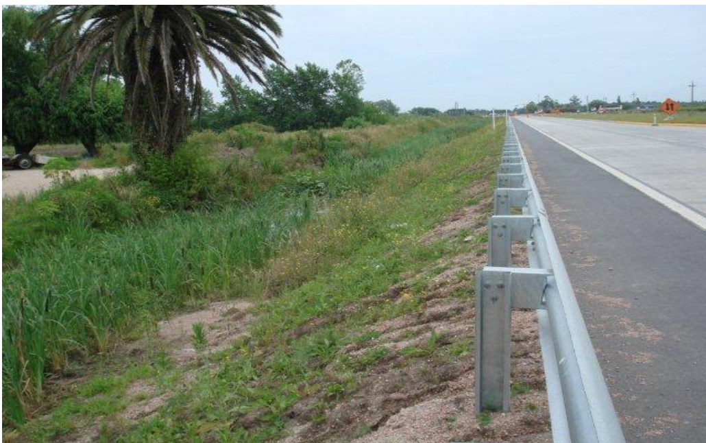
CANAL CAÑADA EL DRAGÓN – TRAMO MELILLA RUTA 5
