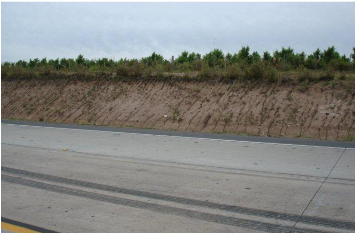
TRAMO 6+025 A 5+600. FALTA REVESTIMIENTO CONTRA TALUD.
