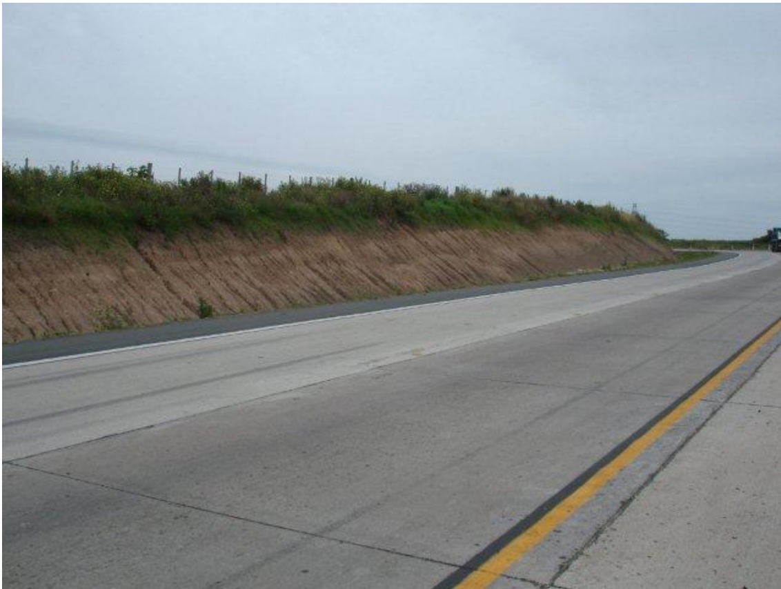
DESMONTE EN CURVA 4+000 AL 4+100 LADO (+). FALTA REVESTIMIENTO CONTRATALUD.
