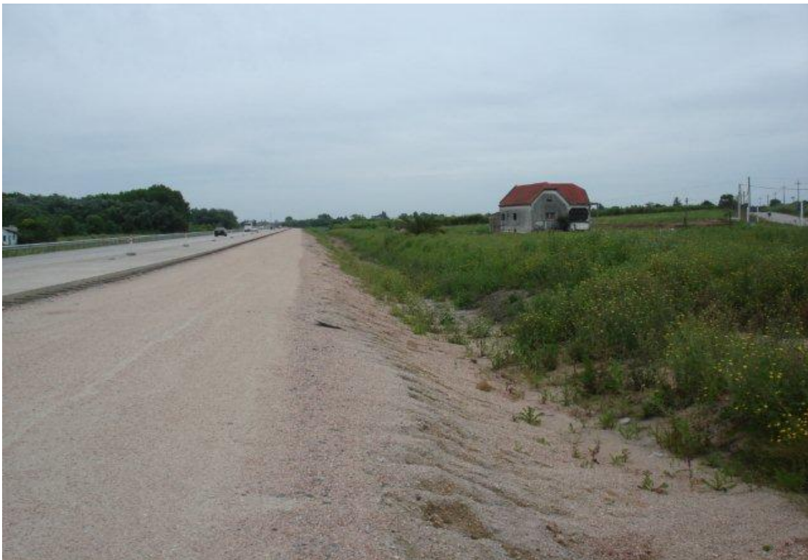
CUNETA/CANAL CAÑADA EL DRAGÓN LADO A (-): TRAMO FAUQUET – PASA VACA. FAJA EMPASTADA, FALTA REVESTIMIENTO VEGETAL DEL TALUD.
