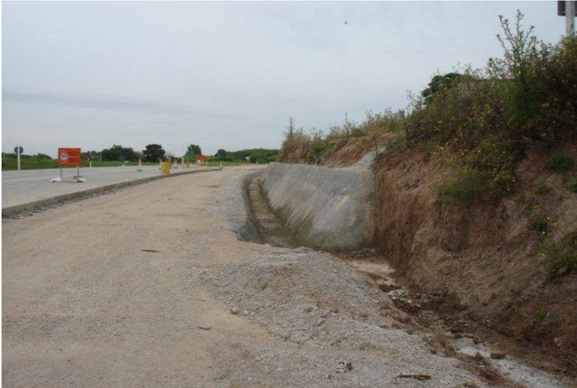
CEMENTADO DE CUNETA TIPO CALLE 1 (CAMINO LA RENGA) Y EMPALME FAUQUET LADO A (-). FALTA REVESTIMIENTO DE HORMIGÓN. TALUDES 1.5V POR 1H.
