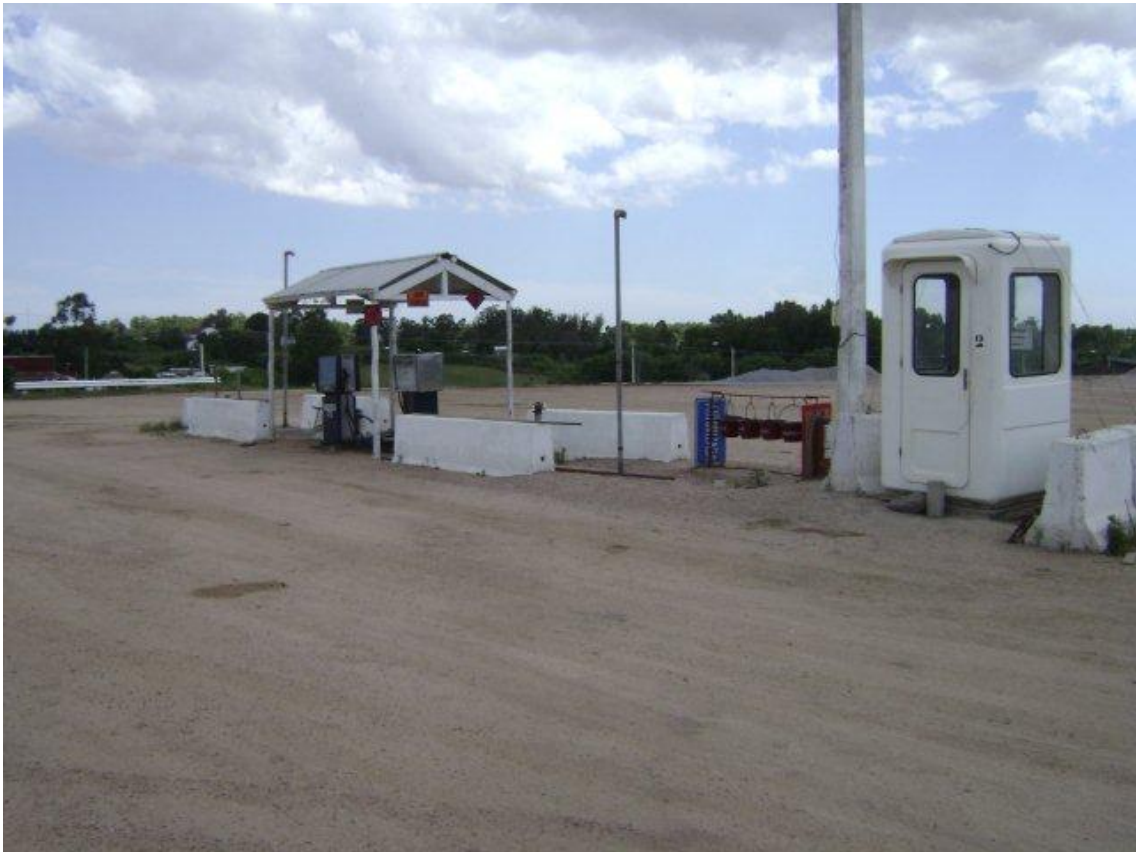
Surtidores de combustible, con elementos de seguridad.
