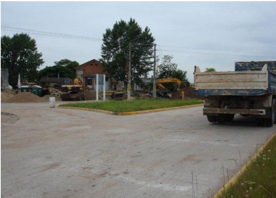
EMPALME MELILLA CON ISLETAS EMPASTADAS – AL FONDO OBRA EN PLANTA DE BOMBEO DE OSE A CARGO DE TEYMA
