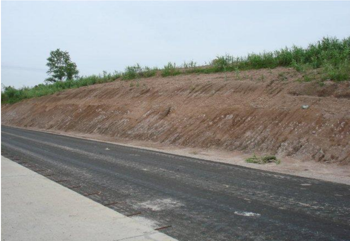
DESMONTE TRAMO 3+350 A 3+475 A (-). FALTA REVESTIMIENTO TALUDES.
