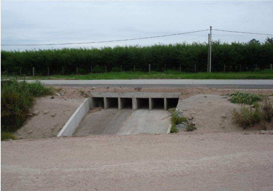
BOCA DE SALIDA DE ALCANTARILLA CRUCE FAUQUET – FALTA CONFORMACIÓN DE TALUD Y REVESTIMIENTO VEGETAL.
