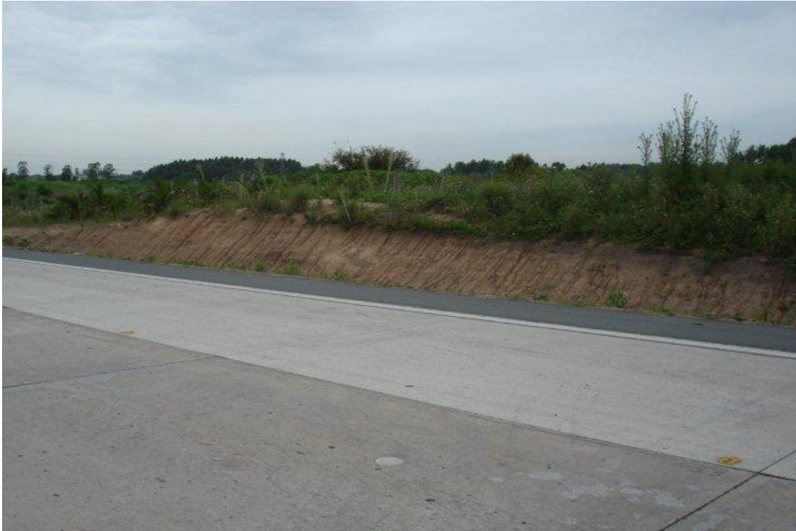
DESMONTE TRAMO 2+400 A 2+600 A (+). FALTA REVESTIMIENTO VEGETAL CONTRATALUD.
