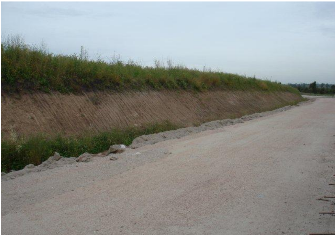
CONTRATALUD DESMONTE EN CURVA LADO A (-), TRAMO 2+350 A 2+600. FALTA REVESTIMIENTO VEGETAL.
