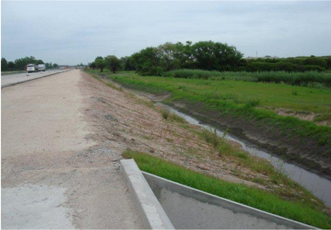
TRAMO PASA VACA - MELILLA LADO A (-) CANAL Y FAJA EMPASTADA – FALTA REVESTIMIENTO VEGETAL DE TALUD
