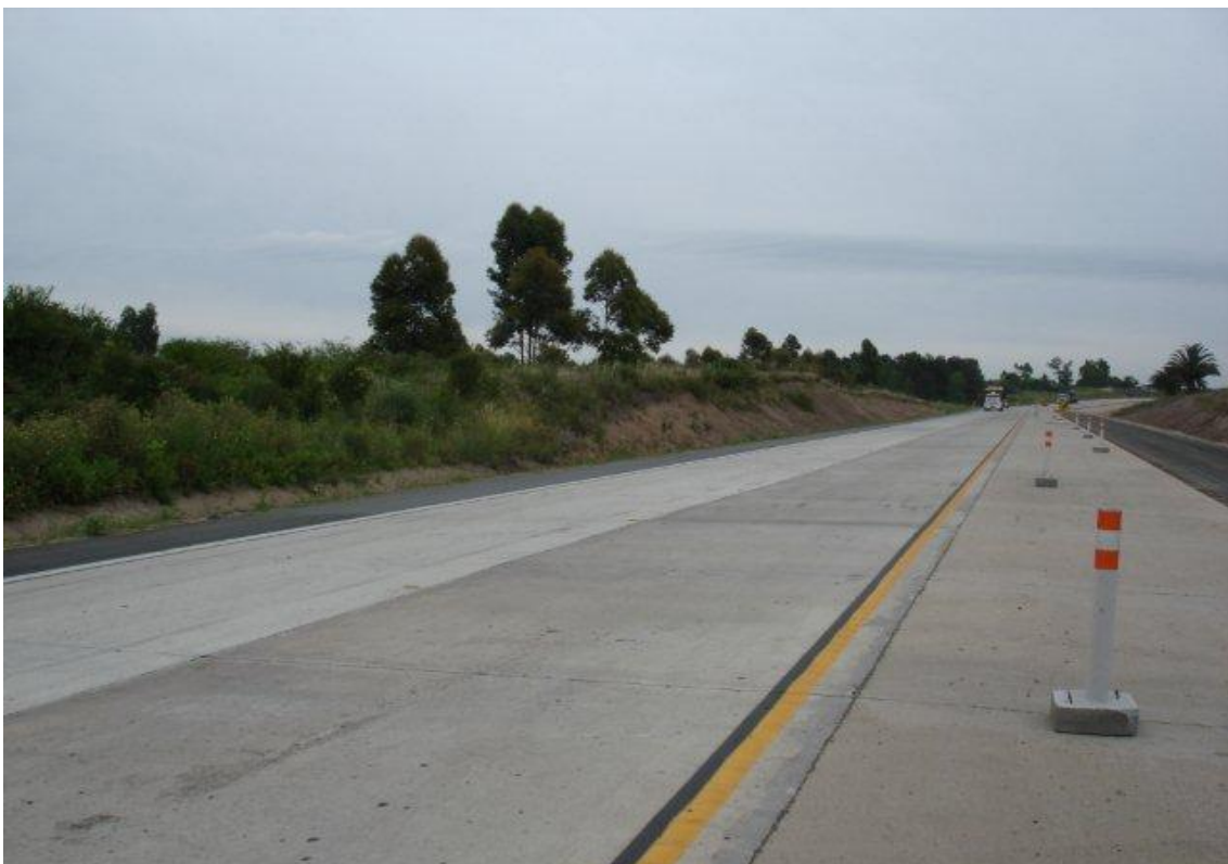
DESMONTE TRAMO 2+700 A 2+900. FALTA REVESTIMIENTO VEGETAL CONTRATALUD.
