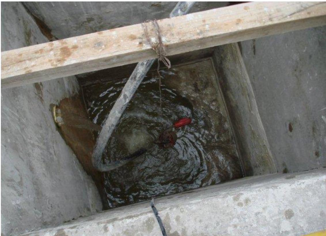
BOMBA PARA RETORNO A TANQUE AUSTRALIANO. TERCER ETAPA DE PILETA DE DECANTACIÓN.
