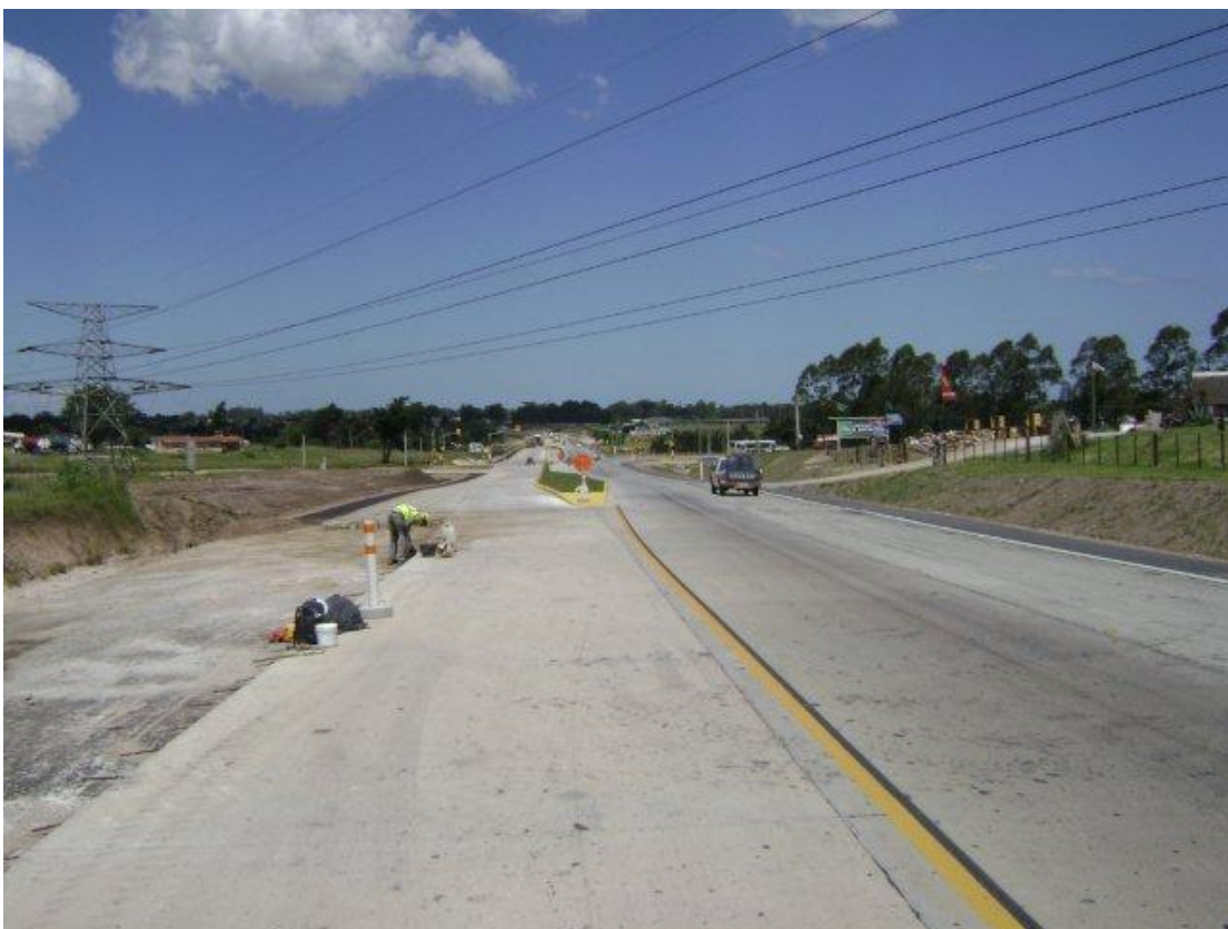
Vista del empalme del ACP con Cno. Mendoza, progresivas menores (ver señalización provisoria, pasto cortado lado sur, y cuarto carril en preparación para su pavimentación).
