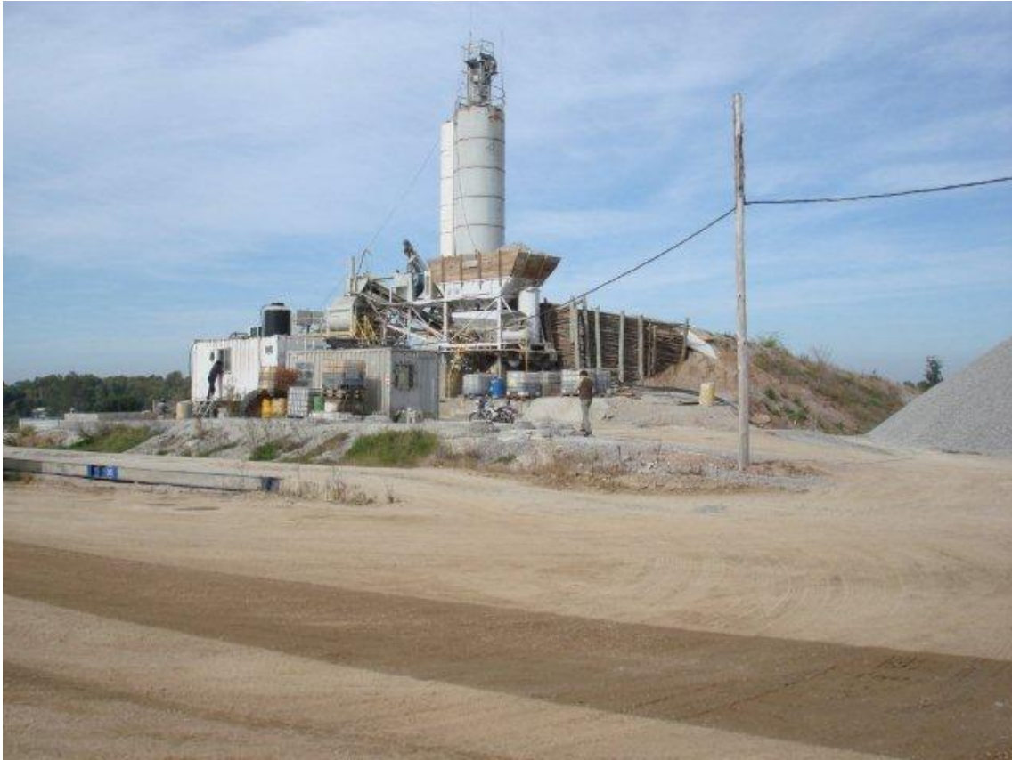
PLANTA DE HORMIGÓN Y BALANZA DE PESAJE DE CAMIONES – HORMIGONES ARTIGAS. VER RIEGO DE AGUA PALIATIVO DE POLVO.
