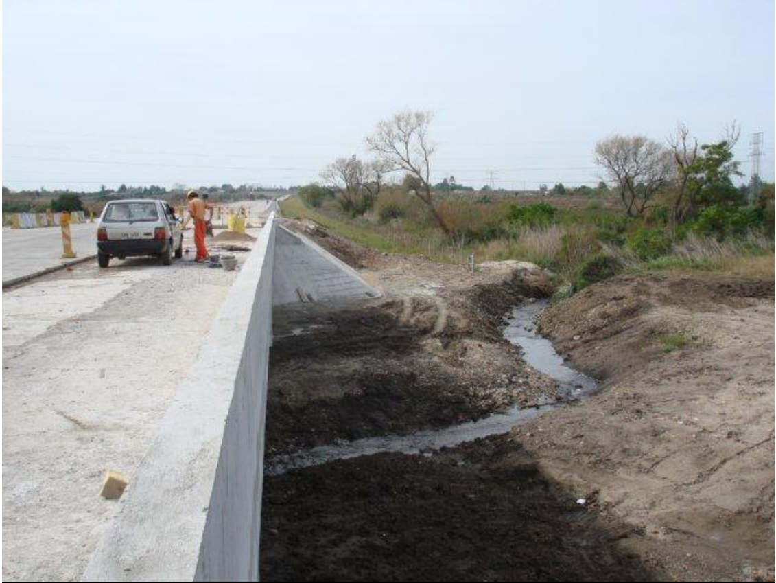
ENSANCHE Y REFUERZO DEL PUENTE MIGUELETE – VISTA DEL ENCAUZAMIENTO DEL CAUCE AGUAS ABAJO.
