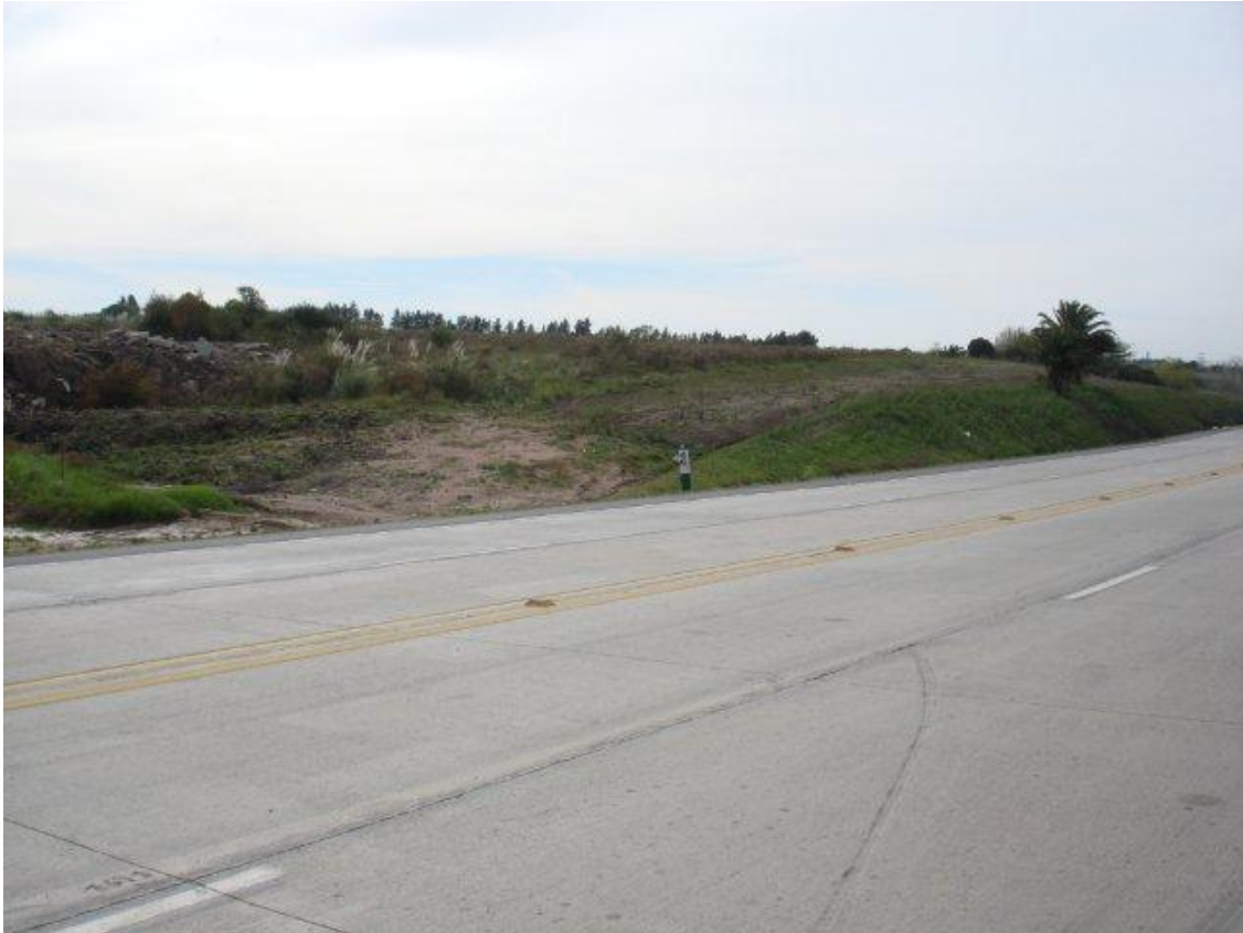
TRAMO FAUQUET A CMG LADO A (-) – CUNETETA DE CORONAMIENTO EN BORDE SUPERIOR DE CONTRA TALUD PARA EVITAR EROSIÓN.
