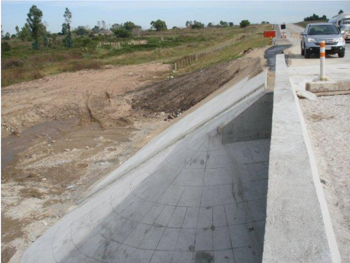
ENSANCHE Y REFUERZO DEL PUENTE MIGUELETE – VISTA DEL CUARTO DE CONO SW.
