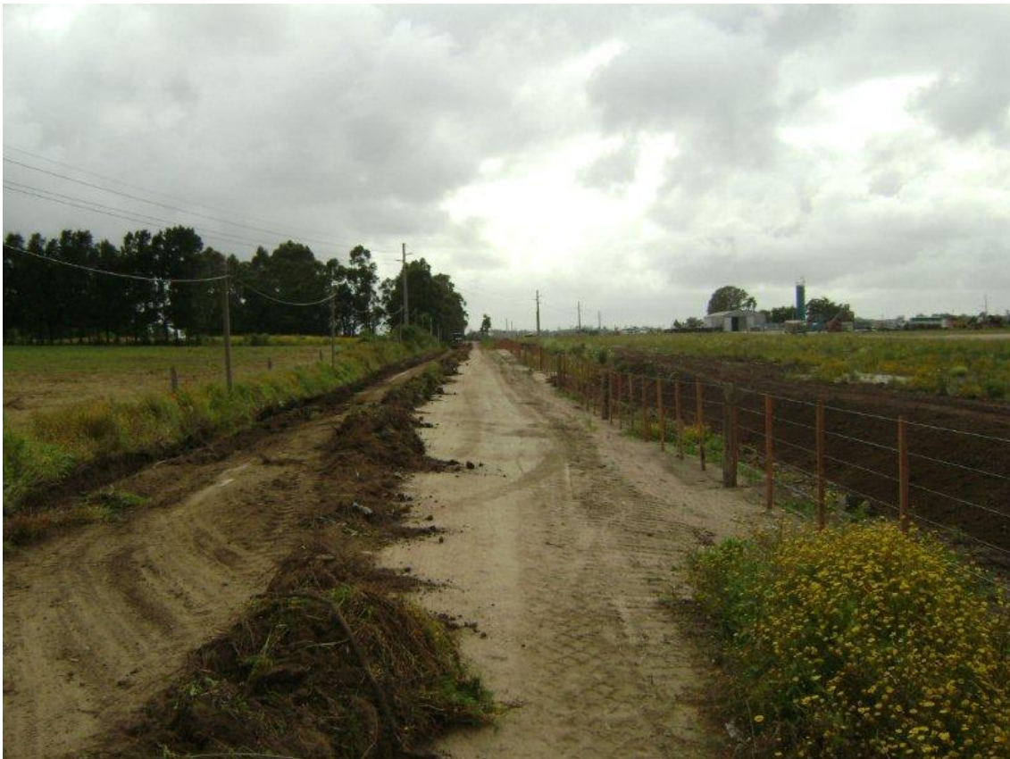
ACONDICIONAMIENTO DE CAMINO BENITO BERGES, POR EL CUAL SE ACCEDE AL CITADO PREDIO (LIMPIEZA DE CUNETAS, RECONFORMACIÓN Y RECARGO DE PLATAFORMA). AL FONDO, OBRADOR DE COLIER SA. DICIEMBRE 2009.
