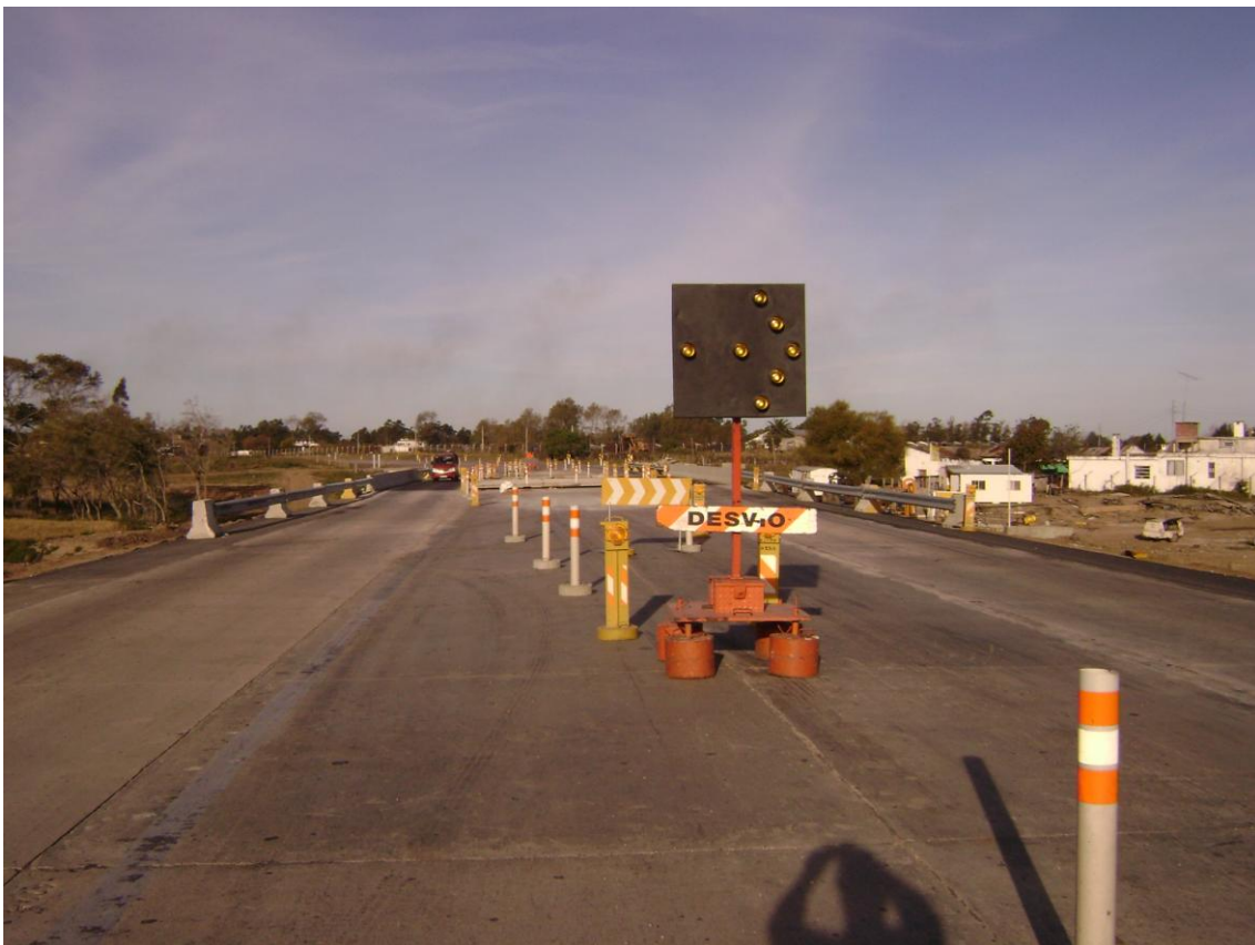
DESVIO SOBRE PUENTE Aº MENDOZA, PROGRESIVAS MENORES. FALTA EJECUTAR EL SOBREPISO EN LOS DOS CARRILES CENTRALES DEL PUENTE.
