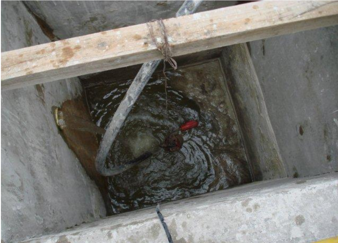
BOMBA PARA RETORNO A TANQUE AUSTRALIANO. TERCER ETAPA DE PILETA DE DECANTACIÓN.
