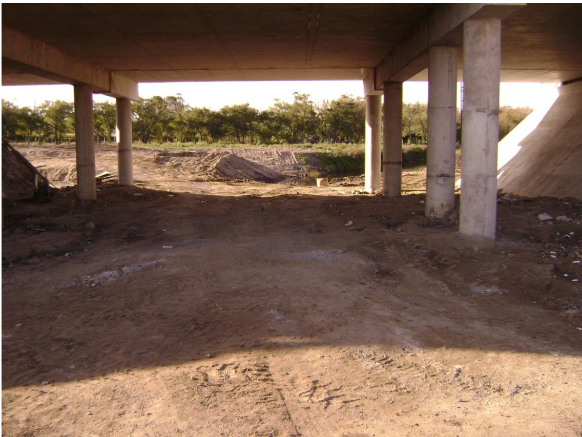
CAUCE DEL Aº MENDOZA, PENDIENTE DE REGULARIZACIÓN BAJO EL PUENTE.
