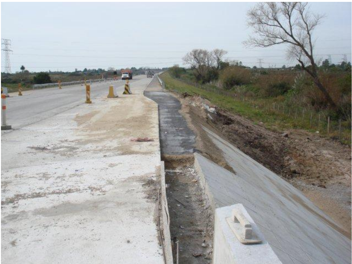
ENSANCHE Y REFUERZO DEL PUENTE MIGUELETE – VISTA DEL CUARTO DE CONO SE.
