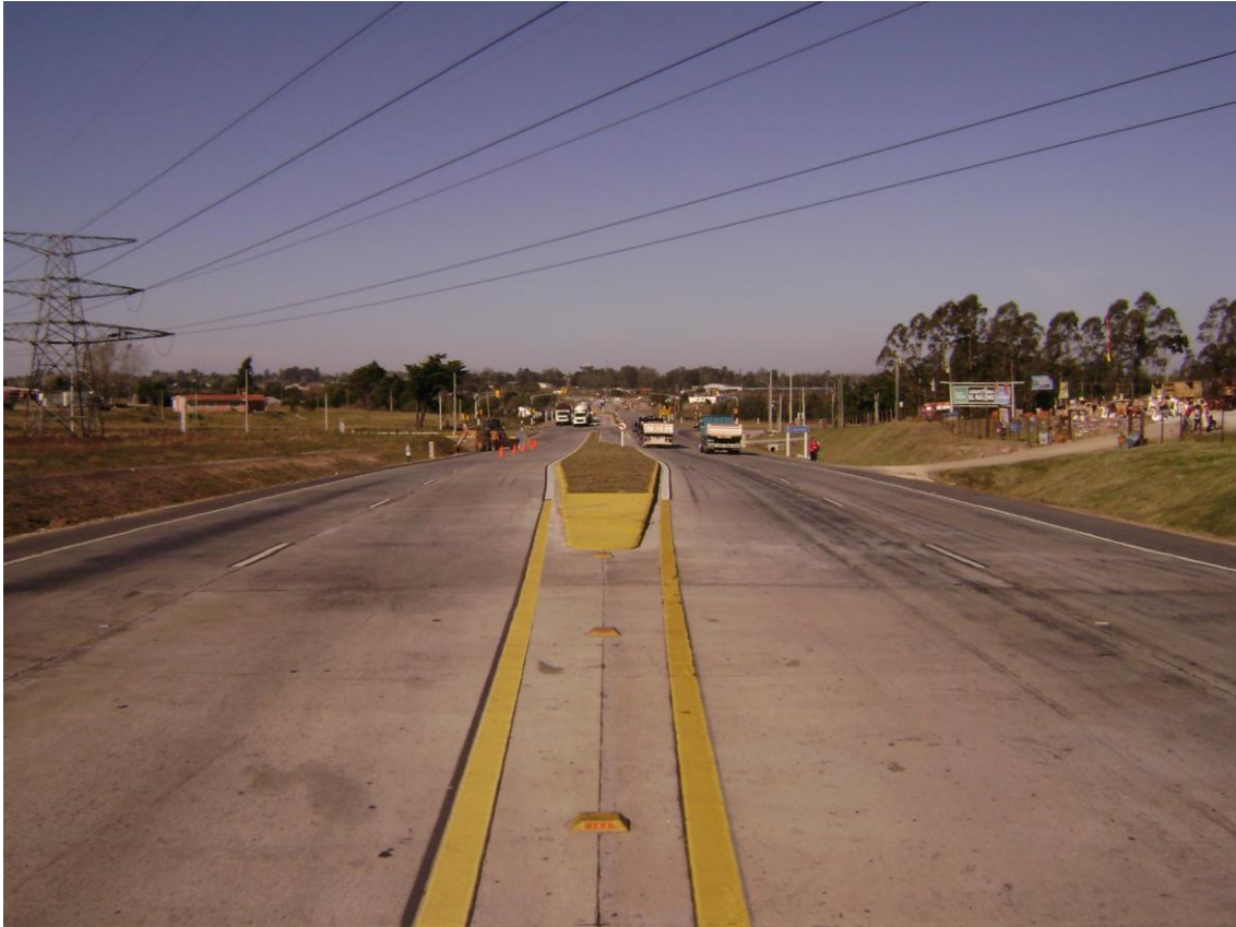
EMPALME DEL ACP CON CNO. MENDOZA, PROGRESIVAS MENORES. SEÑALIZACION TERMINADA, CANTERO EMPASTADO.
