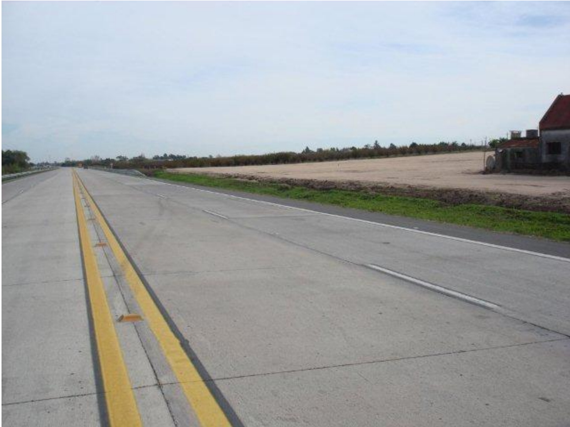
CANAL CAÑADA EL DRAGÓN LADO A (-): TRAMO FAUQUET – MELILLA. CONTRA TALUD EMPASTADO.
