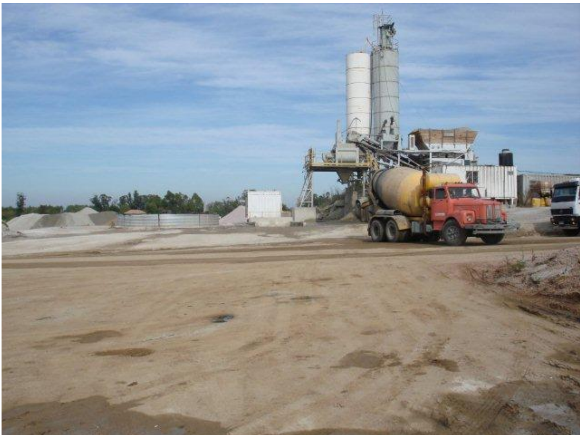
PLANTA DE HORMIGÓN DE HORMIGONES ARTIGAS. AL FONDO ZONA DE ACOPIOS DE AGREGADOS PÉTREOS.
