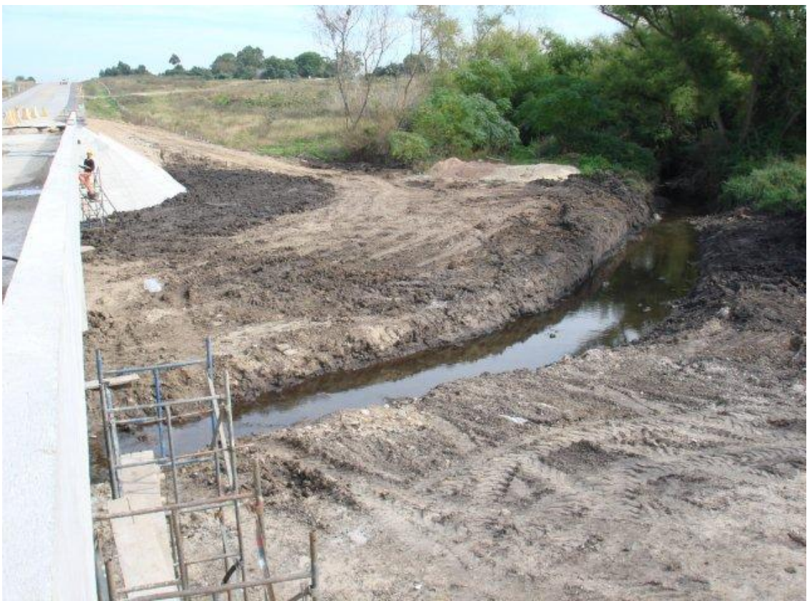
ENSANCHE Y REFUERZO DEL PUENTE MIGUELETE – VISTA DEL ENCAUZAMIENTO DEL CAUCE AGUAS ARRIBA.
