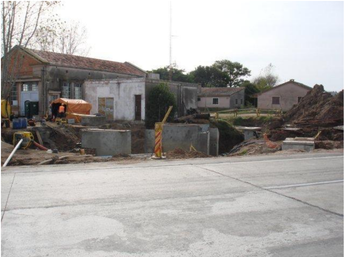
EMPALME MELILLA – AL FONDO OBRA EN PLANTA DE BOMBEO DE OSE A CARGO DE TEYMA Y ESPINA
