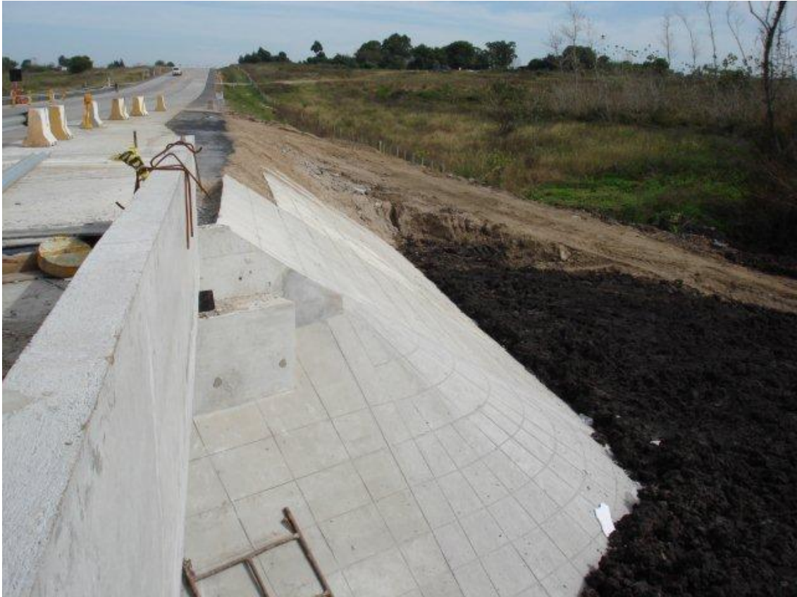
ENSANCHE Y REFUERZO DEL PUENTE MIGUELETE – VISTA DEL CUARTO DE CONO NW.
