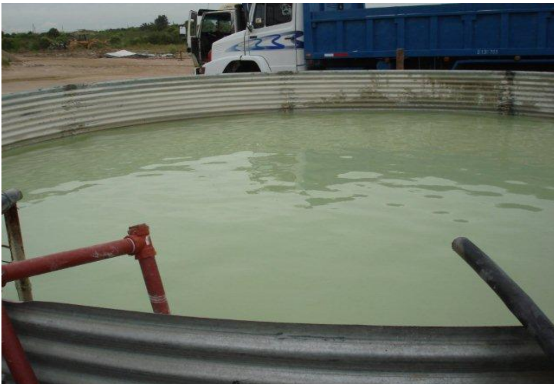
TANQUE AUSTRALIANO. DEPÓSITO DE AGUA PARA ELABORACIÓN DE HORMIGÓN.
