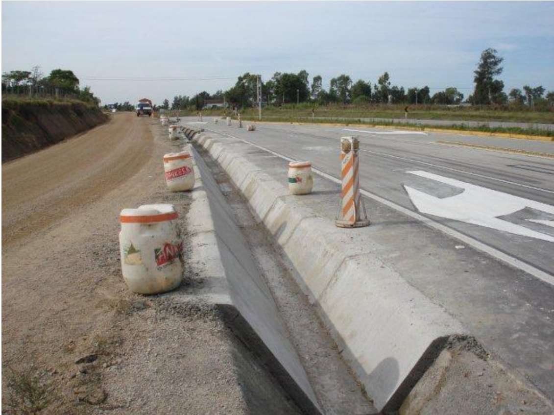
REVESTIMIENTO DE HORMIGÓN EN EJECUCIÓN DE LA CUNETA CANAL ENTRE ACP Y LA RENGA. FINALIZACIÓN PREVISTA PARA 30 DE ABRIL 2010.
