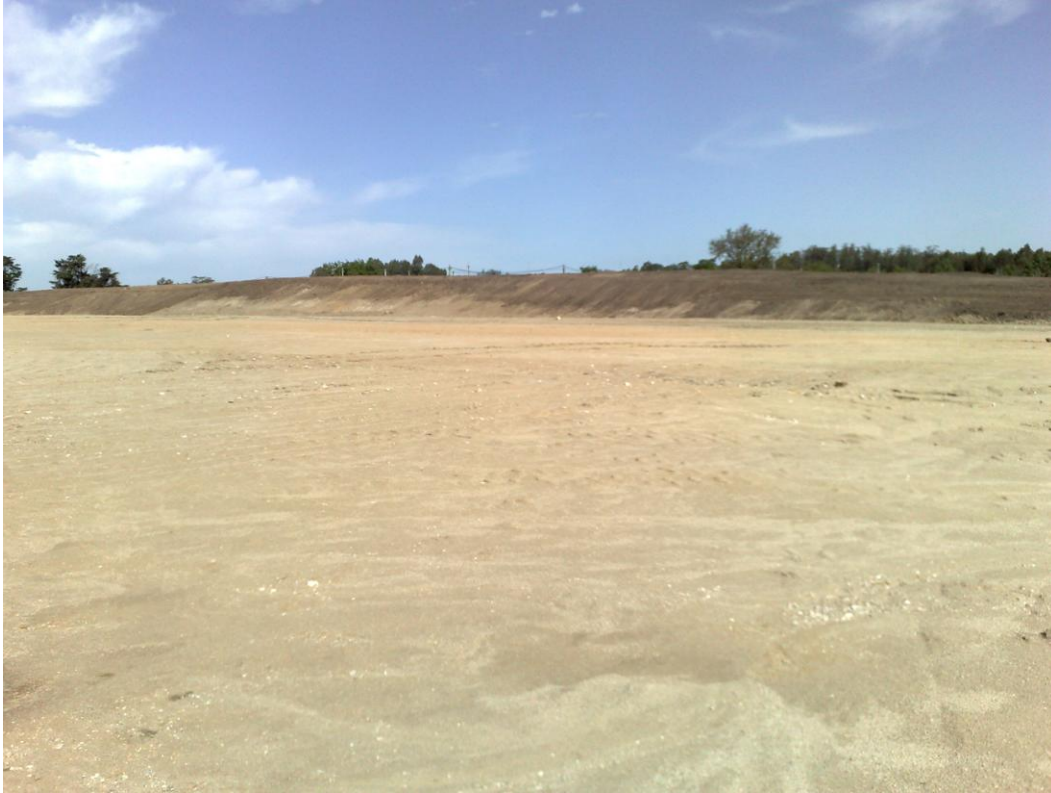
Conformación del piso en pendiente evitando la acumulación de agua y taludes suaves y revestidos
