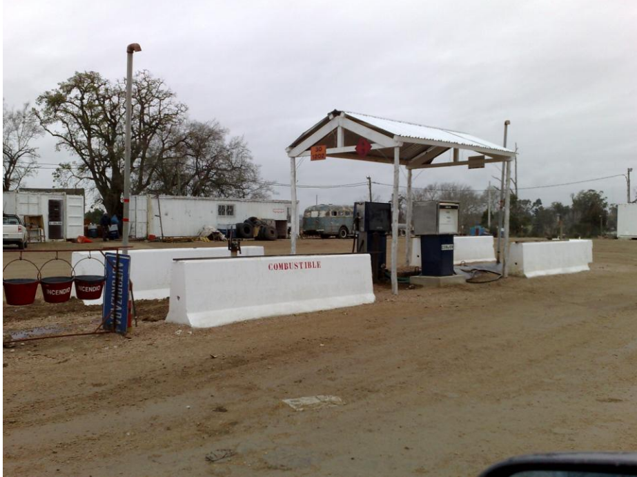
Surtidores de Combustible con dispositivos de seguridad.
