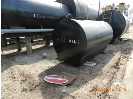
Ilustración 4: Diques de contención hechos de tierra en mal estado luego de lluvias copiosas
