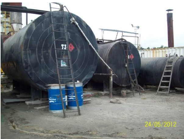
Ilustración 8 – tanques de la planta asfáltica sin contención
