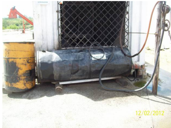
Ilustración 10: Tanques con gas oil para grupo generador sin contención
