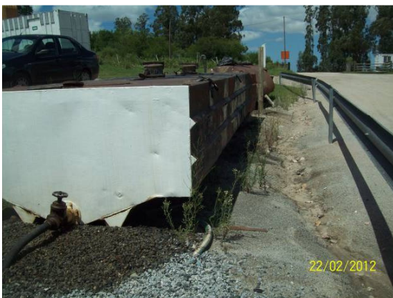
Ilustración 8: Tanques de acopio de combustible sin contención
